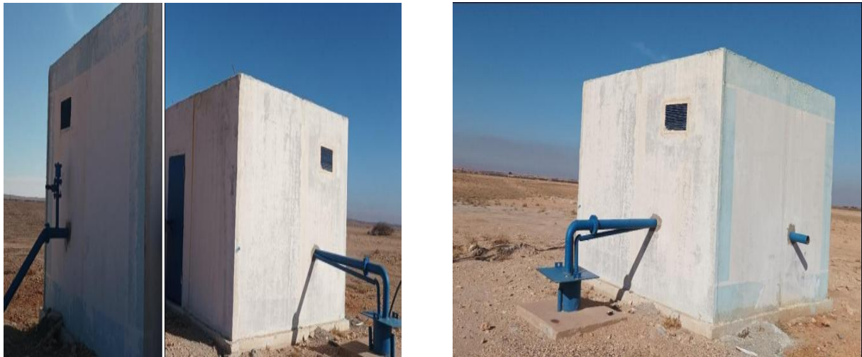
Figure III.11 : Vue général du forage (2025)
