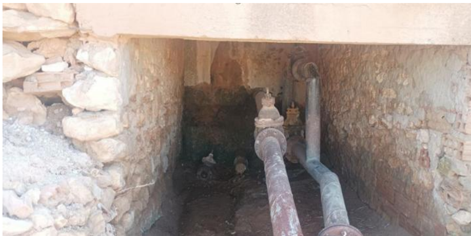
Figure III.16 : Conduites de départs et vidange+ trop plein
