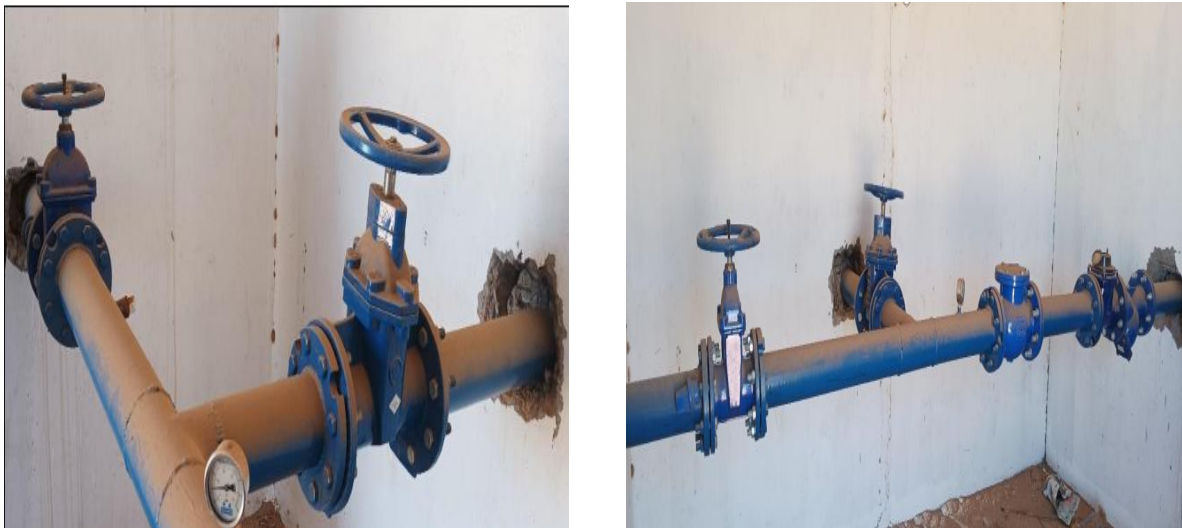
Figure III.12 : Vue sur les équipements du forage F-11
