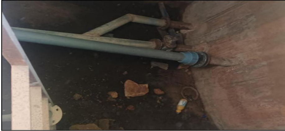
Figure III.18 : Conduites de TP + vidange et conduite de départ
