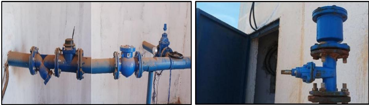
Figure III.6 : Vue sur les équipements hydromécaniques du forage débitmètre en panne, Clapets, ventouse, manomètre et vannes
