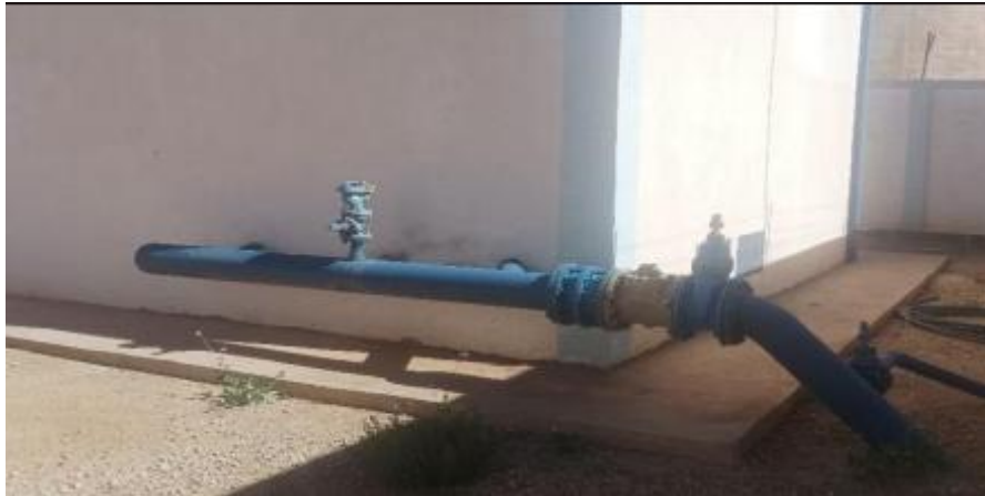
Figure III.21 : Conduite d'arrivée à la station
