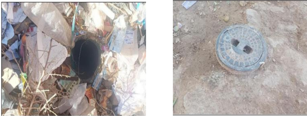
Figure III.23 : Vue sur des vannes situé dans le centre de l'ACL Bouaiche
