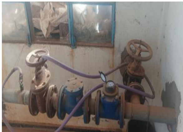
Figure III.10 : Vue sur les équipements du forage F-1 Kerfouf
