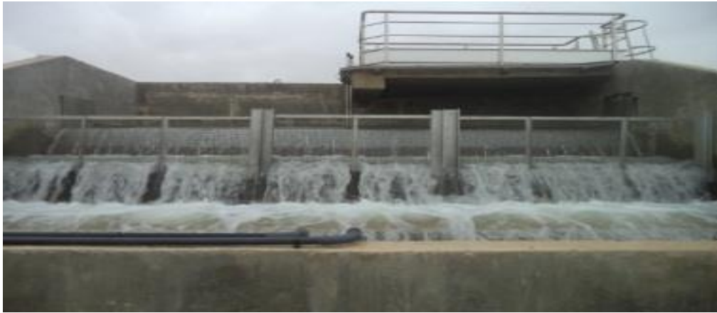
Figure 26 : La cascade d'aération [29]
