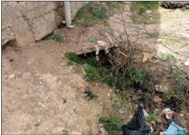
Figure V.3 : Un regard en mauvais état. (Date : 20/02/2024)
