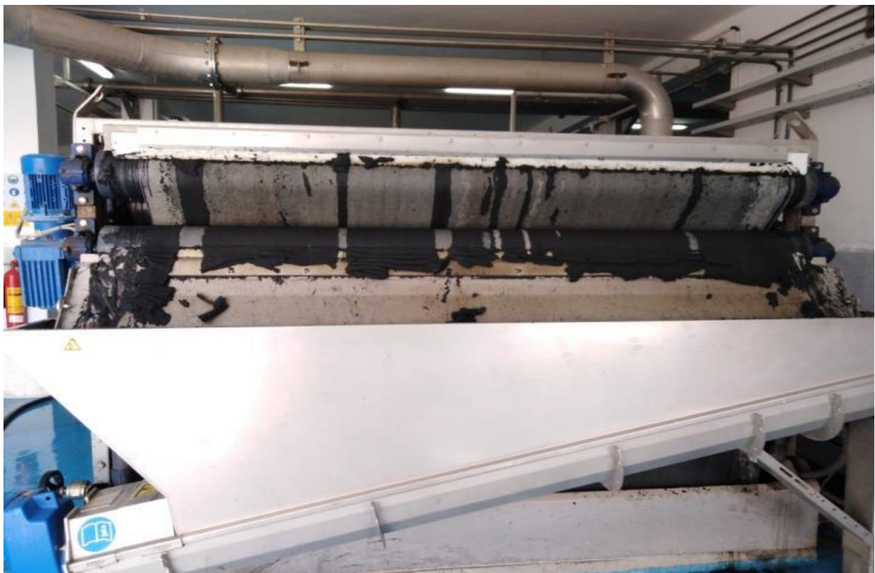
Figure II. 13 : filtre à bande lors de la déshydratation.
