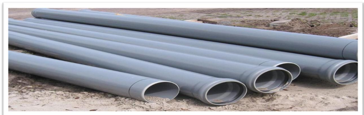
Figure (VI-10) : conduites en PVC.
