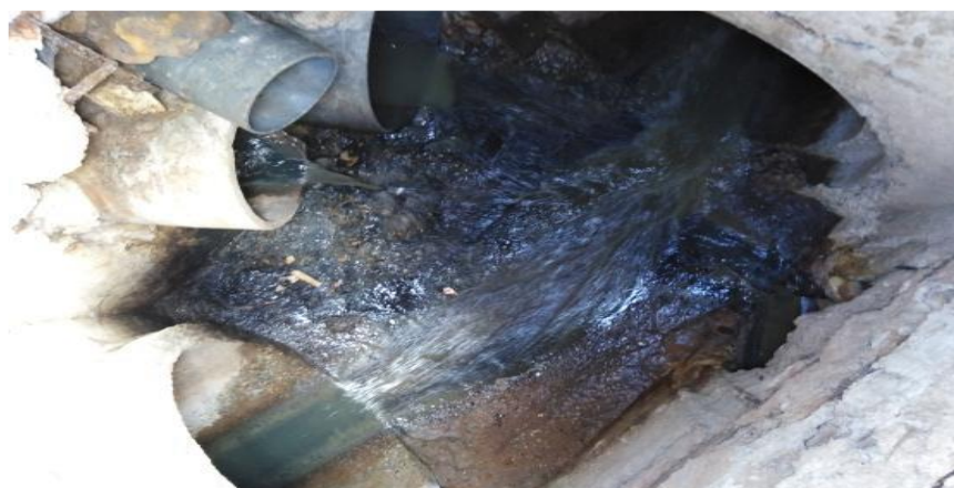
Figure II - 6 : Mauvais jonction entre les conduites et le regard (DRE Tiaret 2025).
