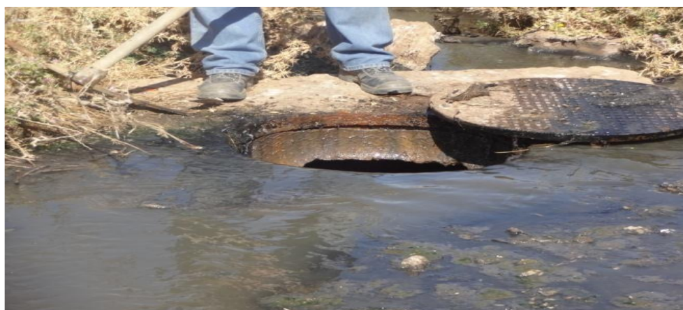
Figure II - 5 : Débordement des eaux au niveau de regard (DRE Tiaret 2025).
