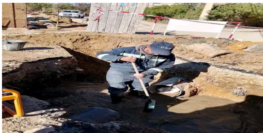
Figure II - 8 : Conduite fissurée (ONA Tiaret).
