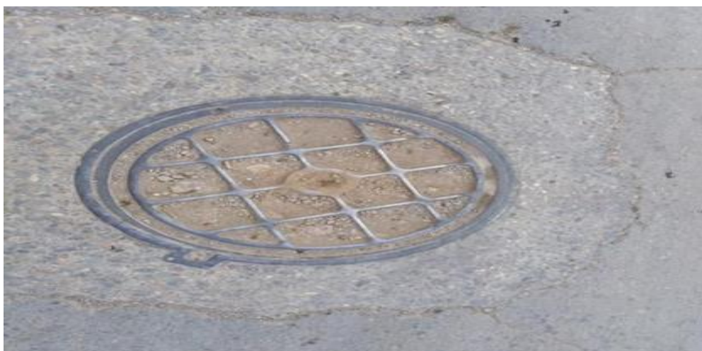
Figure II - 3 : Tampon en font (DRE Tiaret).
