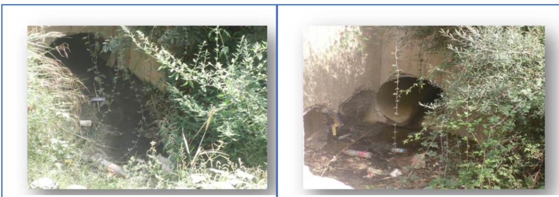
Figure IV.2 Rejet direct d'eaux usées vers la Chaâbat (El Agba Hamra).
