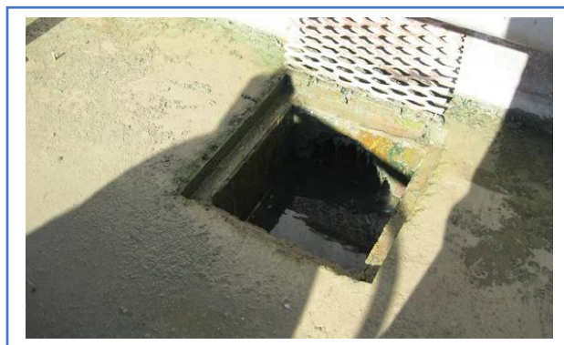
Figure IV.4 Caniveau obstrué par des dépôts (rue Cheikh Ben Aïssa).
