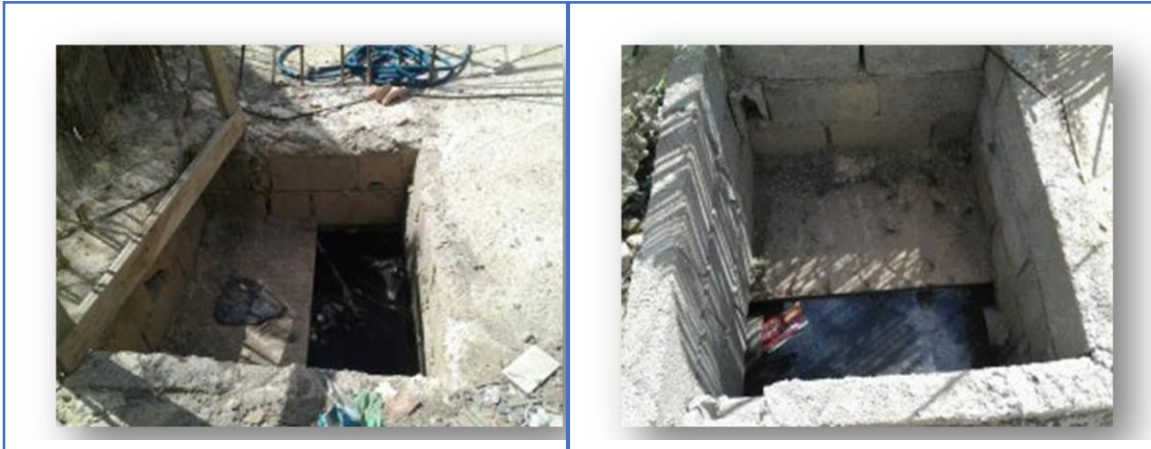
Figure IV.3 Fosses septiques individuelles (Ouled Soltane).
