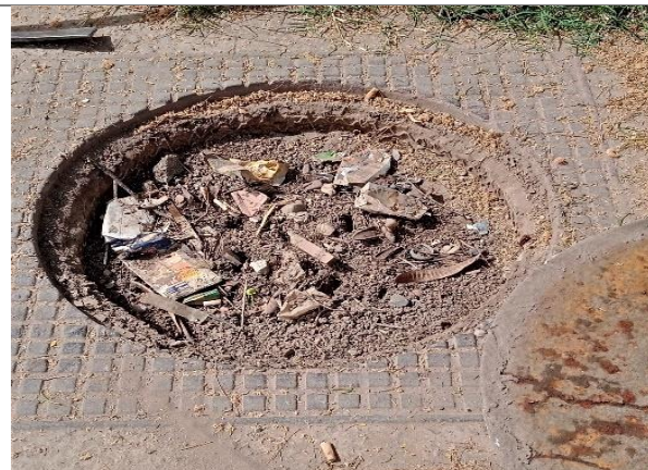
Figure V.2 : Regard remblayé complètement par des terres.
