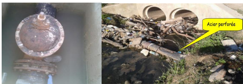
Figure III.4: état de réseaux de distribution.
