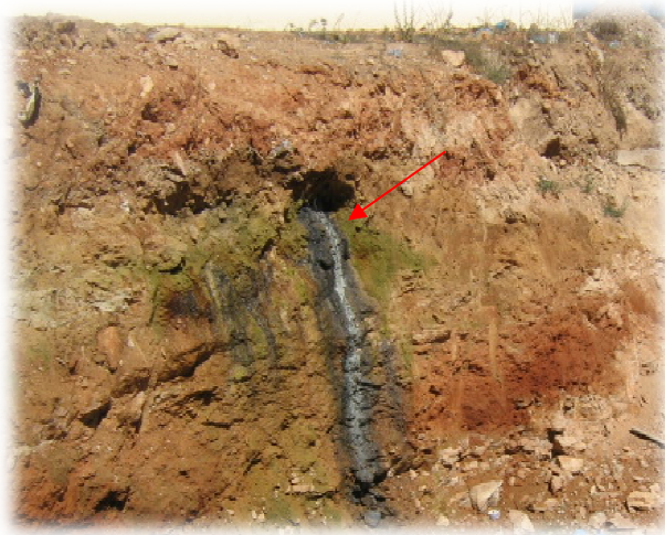
Rupture causant un déversement des eaux usées
