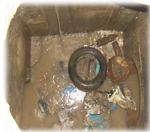
état du regard des eaux pluviales PG
