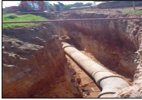
Figure 9.5 : Tranchée ouverte sans blindage
