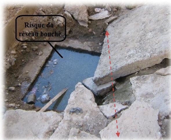
L'effondrement de la chaussée
