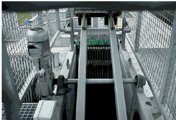
Figure N°09 : un dégrilleur mécanique
