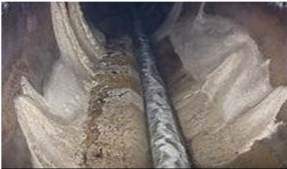
Figure II.5.b : infiltrations dans le collecteur Ravin Blanc.
