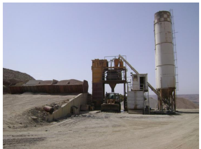
Centrale à béton.
