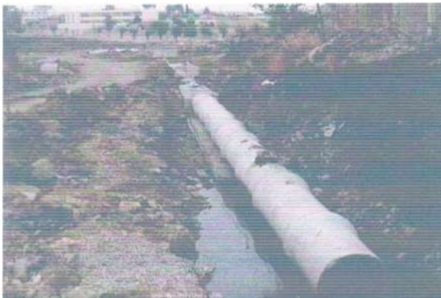
Figure I.2 : Collecteur principal Ø 1000 de type unitaire en cour de réalisation (Didouche Mourad)
