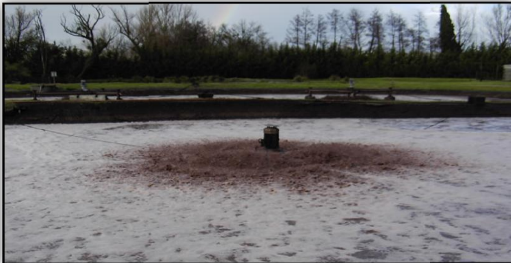
Figure. IV.5 : Photo d'une turbine d'aération.
