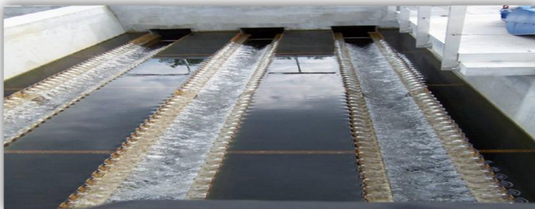
Figure. III.4 : Ouvrage de décanteur
