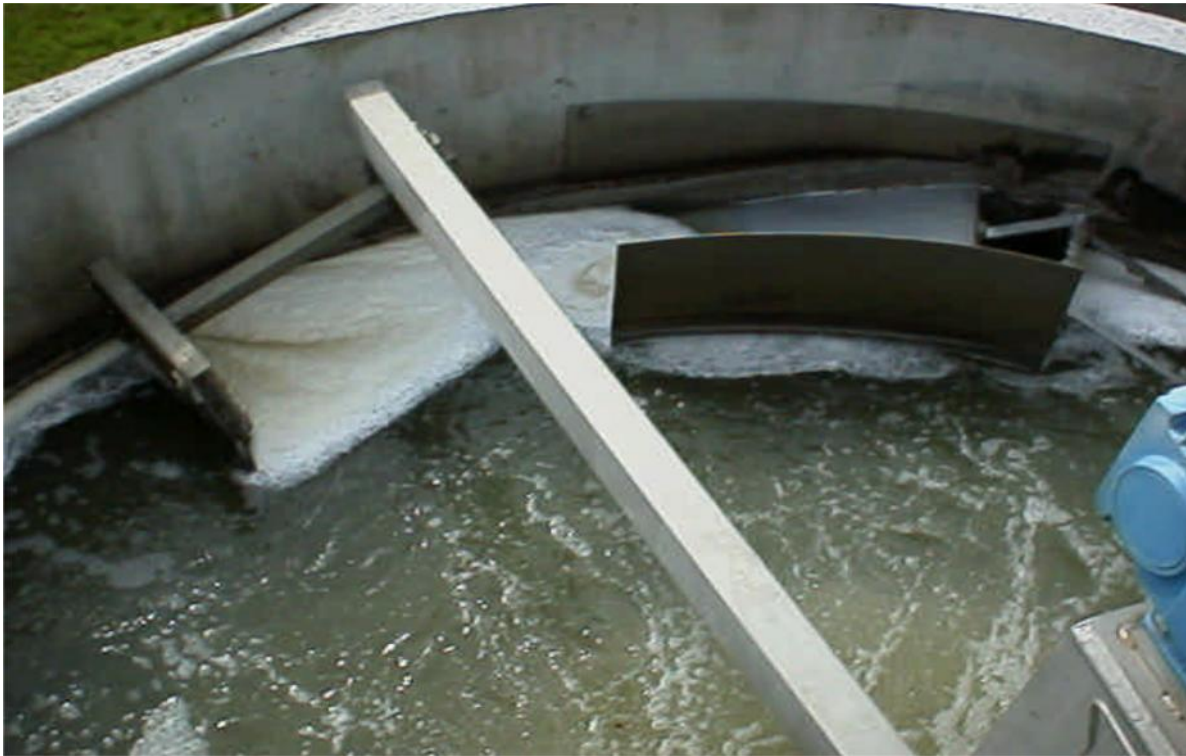
Figure II.4 : Racleur d'un dégraisseur-déssableur
