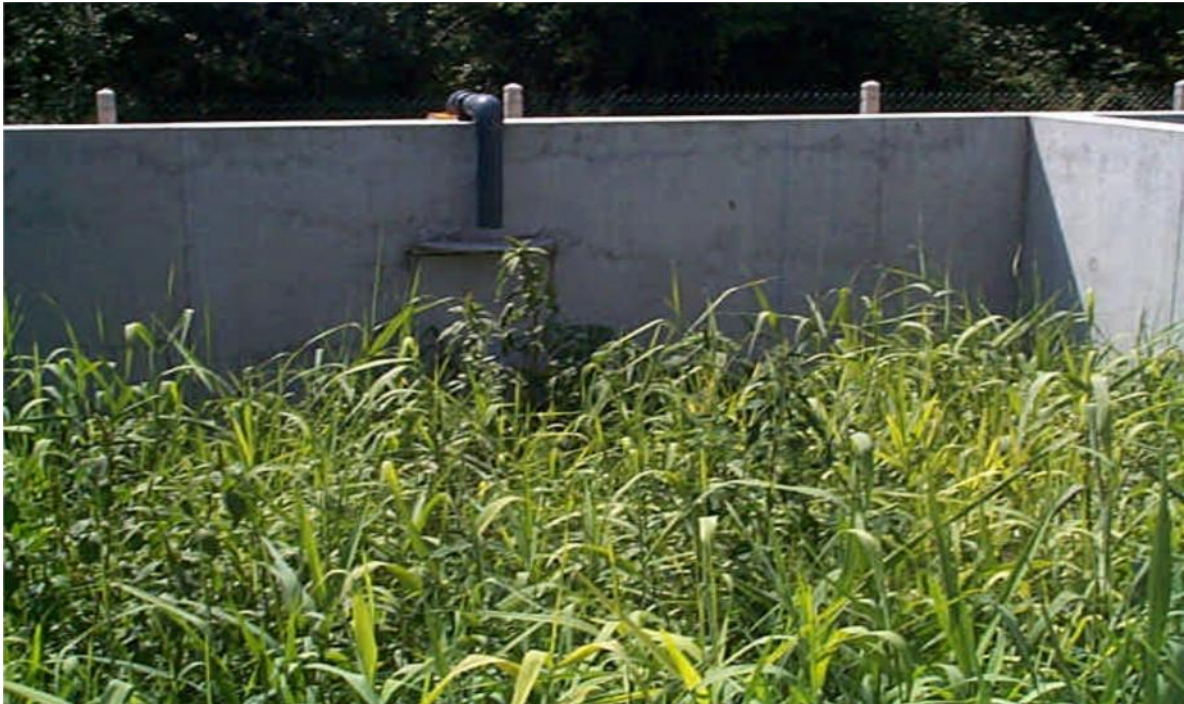
Figure IV.11 : lit de séchage planté de roseaux
