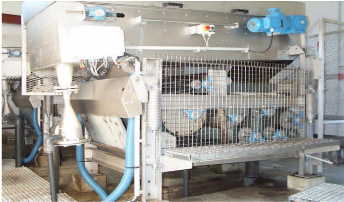
Figure IV.12 : Déshydratation mécanique par filtre à bandes
