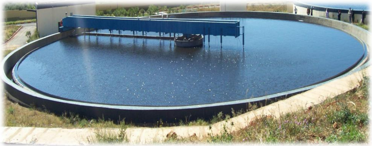
Fig. n°V.5 : décanteur secondaire (clarificateur) de la STEP de TLEMEN
