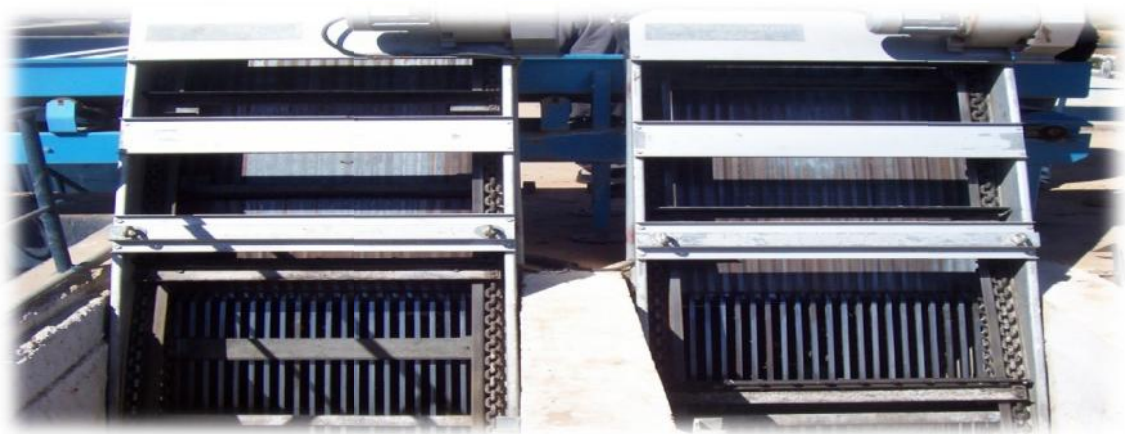
Fig. n°V.3 : deux dérailleurs automatiques de la STEP de la ville TLEMCEN
