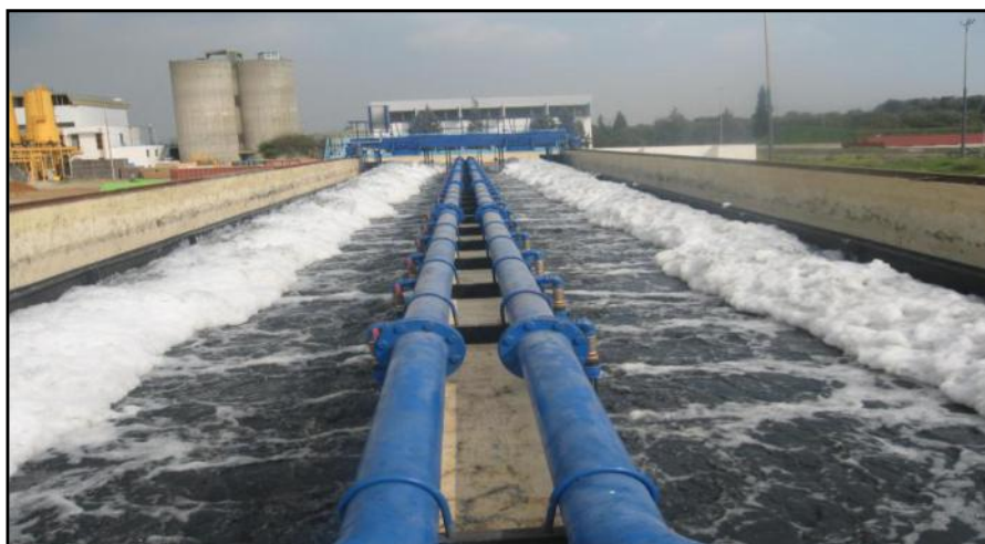
Figure III.7 : deshuileur dégraisseur de la STEP de BARAKI
