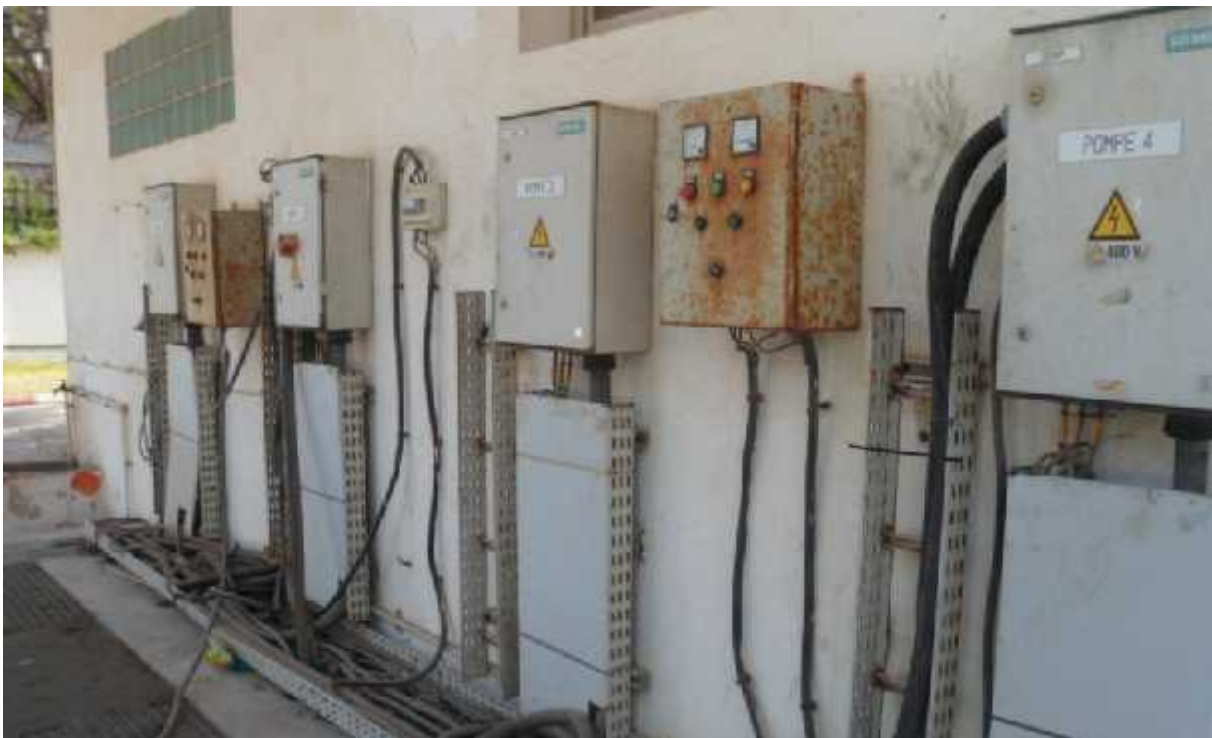
Figure n° II -5: Alimentation électrique des 4 pompes immergées.
