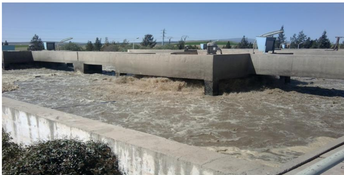
Figure III.17: Bassin d'aération de l'ancienne SETP de la ville de Bordj Bou Arreridj
