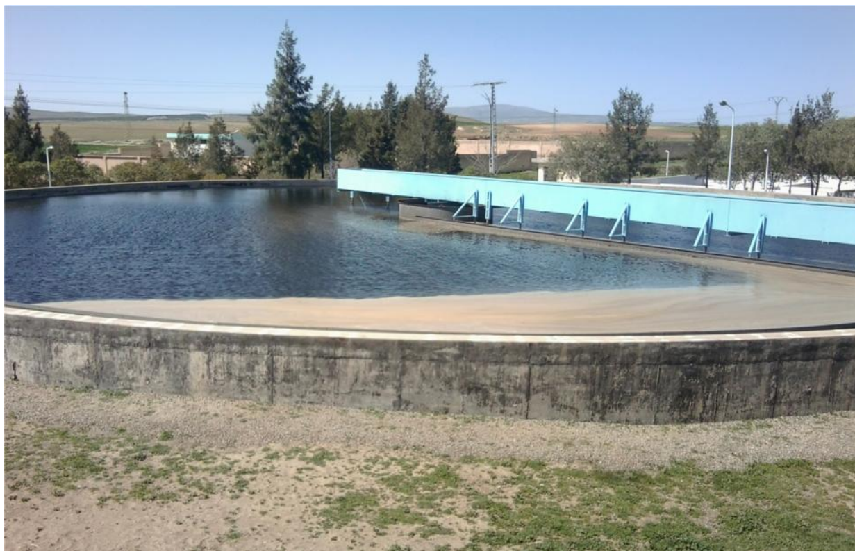
Figure III.18: Clarificateur de L'ancienne SETP de la ville de Bordj Bou Arreridj
