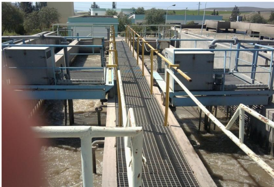
Figure III.7: désableur rectangulaire de l'ancienne SETP de la ville de Bordj Bou Arreridj
