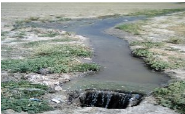
Photo II.7: Vue sur un regard ouvert non aménager
