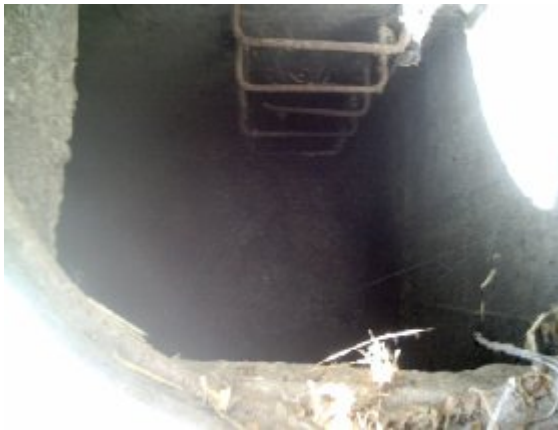
Photo II.15: Regard de visite totalement bouché
