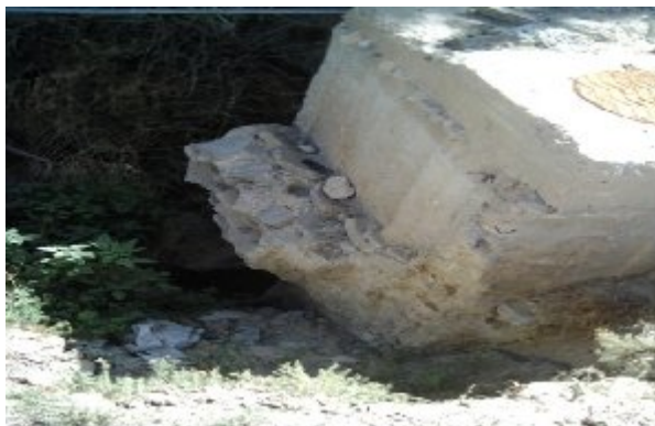
Photo II.13: Regard en état dégradé
