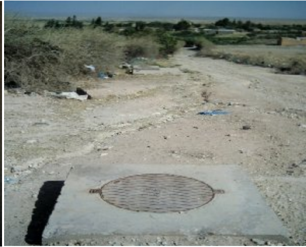
Photo II.10: Les regards d'assainissement sur la ligne allant vers le rejet
