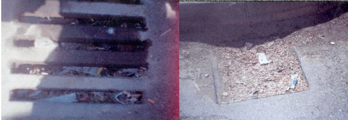
Photo II.20: Bouche d'égout non nettoyée
