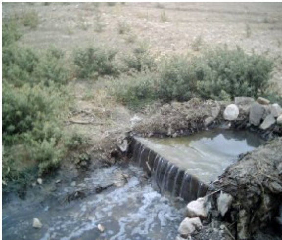
Photo II.11: Regard inondé sur le collecteur allant vers le rejet
