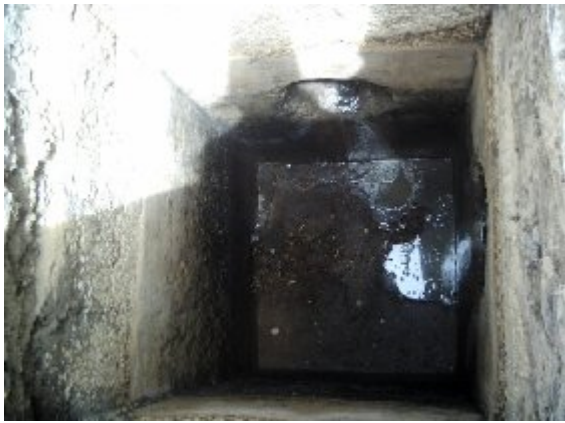
Photo II.5: Vue intérieure d'un regard de Jonction complètement bouché
