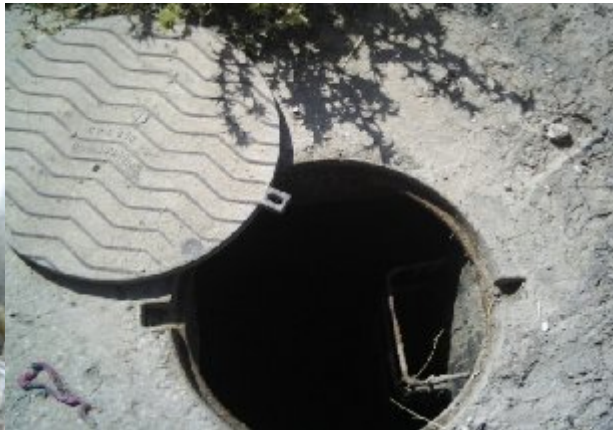
Photo II.16: Vue sur un regard de branchement
