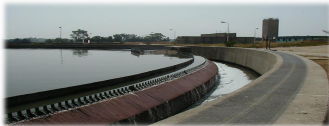
Figure II.8: Décanteur primaire (station d'épuration REGHAIA).
