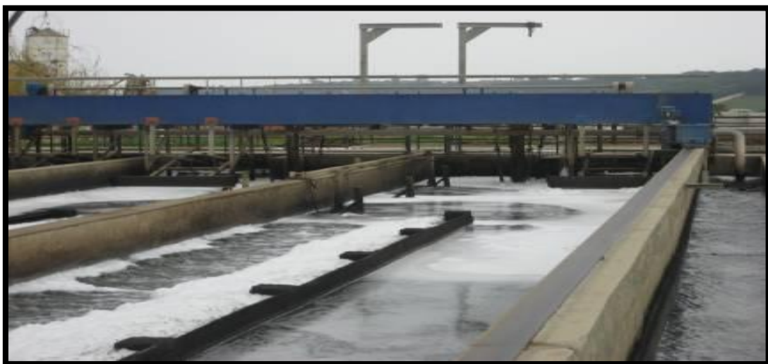
Figure 5 : Dégraisseur-Dessaleur (STEP REGHAÏA).
