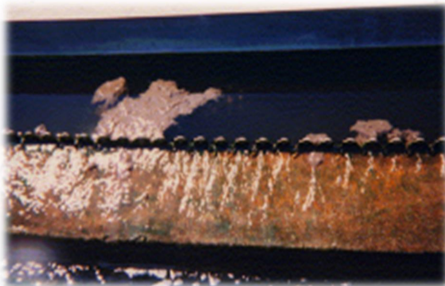
Figure IV.3 : Dénitrification sauvage dans un décanteur
