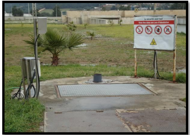
Figure 13 : Poste toutes eaux
