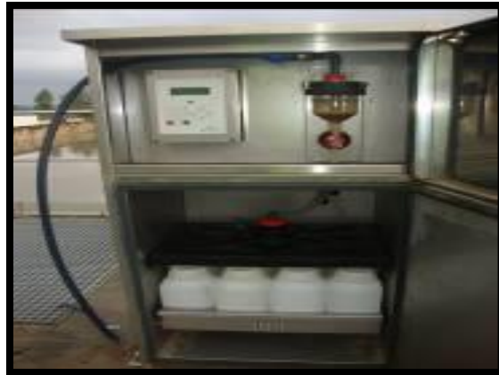
Figure 2 : Ouvrage de comptage (STEP REGHAÏA).
