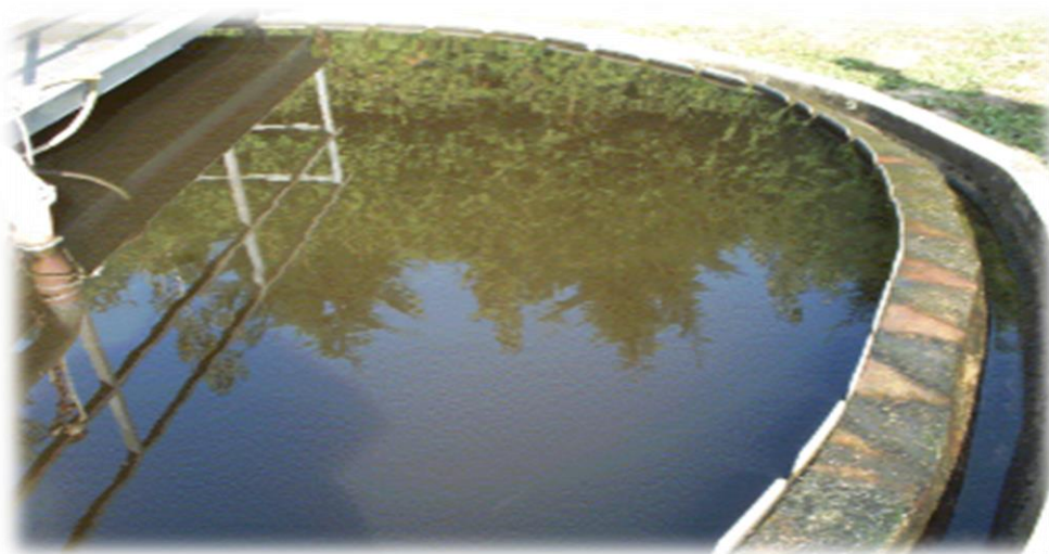
Figure IV.1 : Floculation des boues au niveau d'un décanteur.
