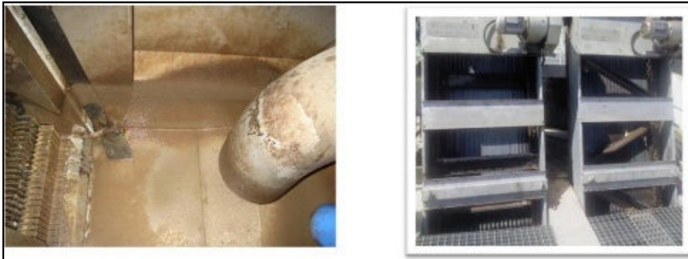
Figure III.3 : Photo d'une grille grossière et fin.
