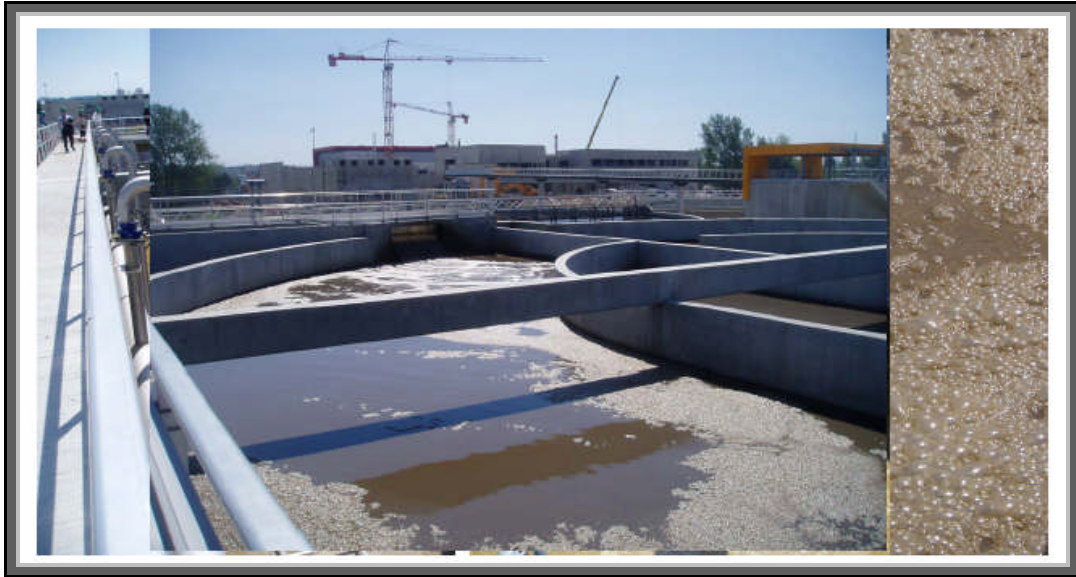
Photo N° 04: Bassin d'aération à boues activées (Thévenot ,2005) .
