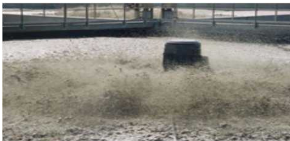
Figure III.4. Bassin d'aération par aérateur de surface.
