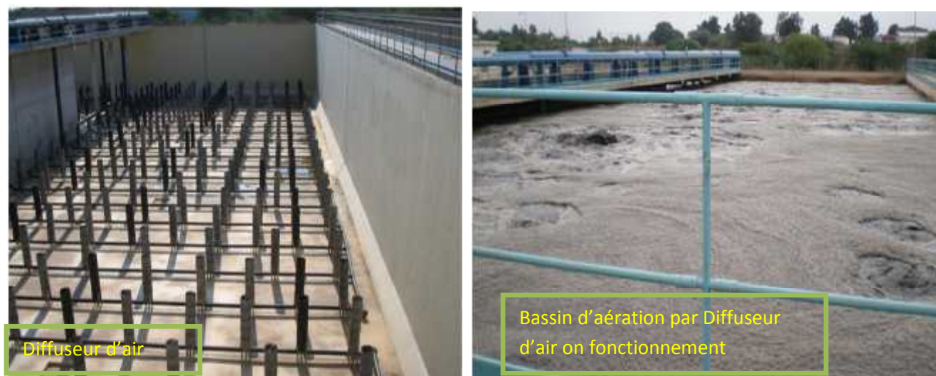
Figure III.3. Bassin d'aération par diffuseur d'air.
