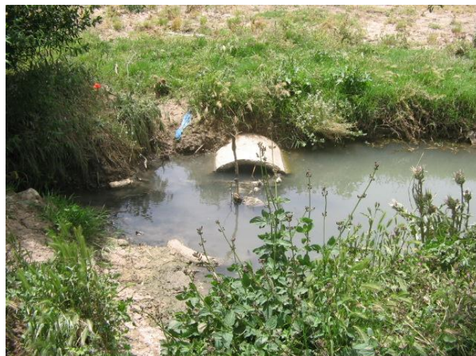
Figure 1-7: Etat de regard (sous bassin8)
