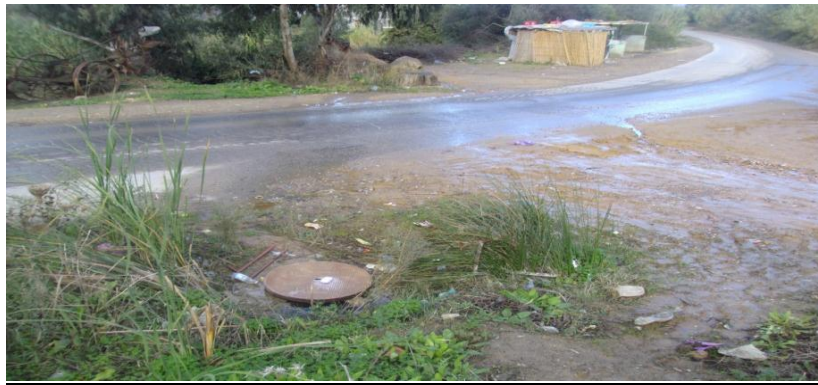
Figure 1-6: Etat de regard (sous bassin8)
