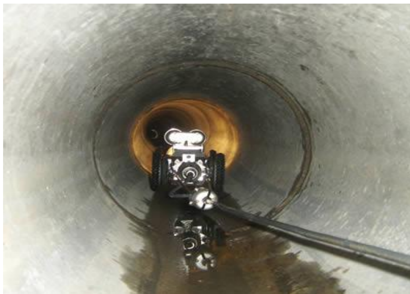
Figure IX.1- Camera utilisée lors de l'inspection televisuelle
