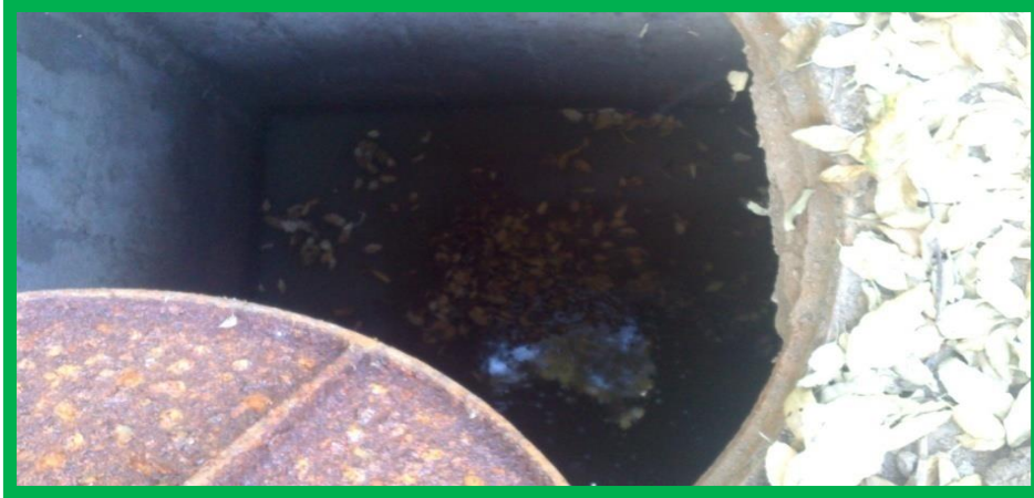
Figure IV.8 : vue de rejet de Sidi Temmam
