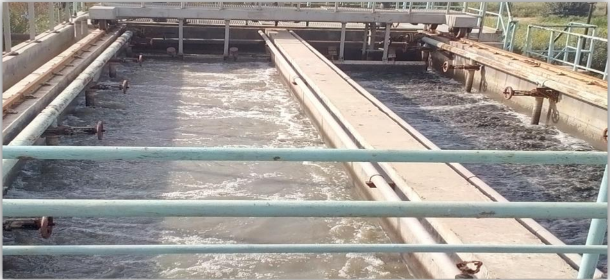
Figure IV .5 : Dessableur rectangulaire de la SETP de la ville de CHLEF.
