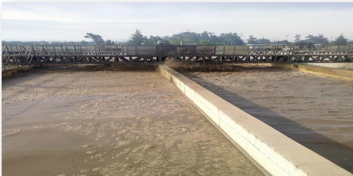
Figure V.2 Bassin d'aération (photo pris de la step de chlef).
