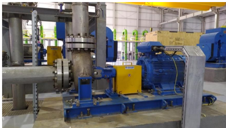
Figure IV- 8: Photo d'une pompe booster
