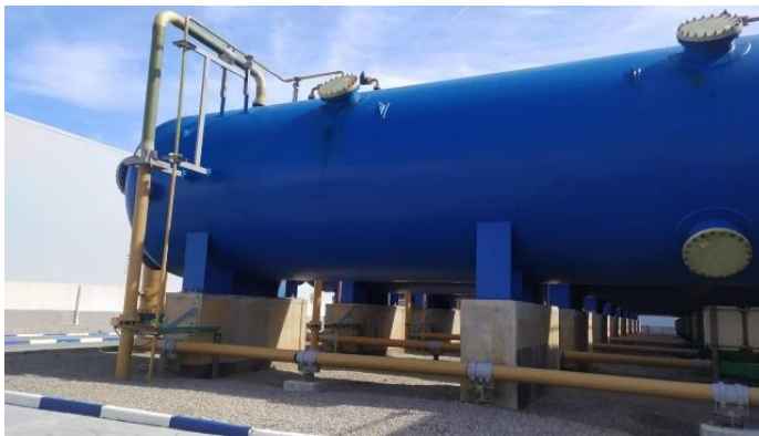
Figure IV- 6: Filtre à sable
