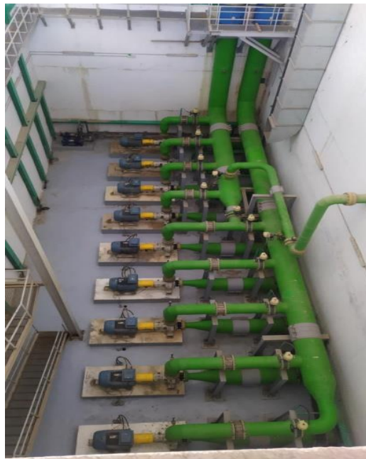
Figure IV- 5: les pompes d'eau brute
