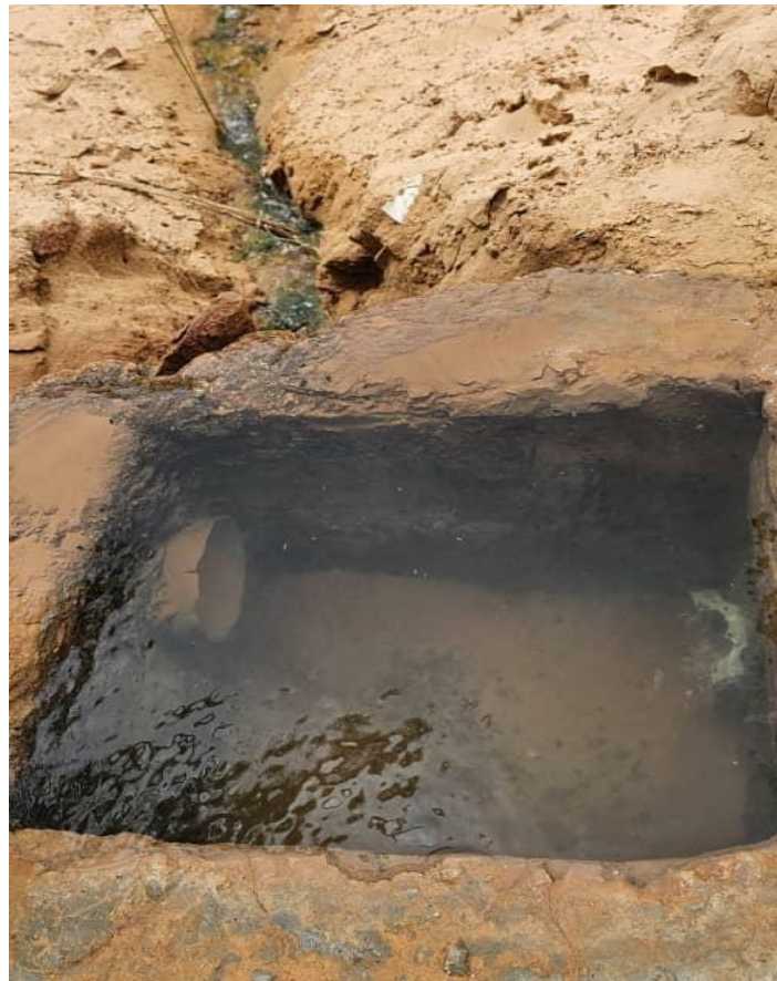
Figure 3.30: Un regard qui fuit et est bouché en sable.
