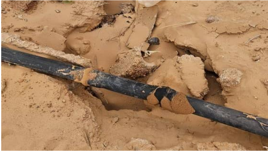
Figure 3.29: 'Une canalisation fuyante.
