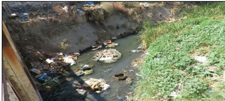
Figure IV.14 Présence de végétations et déchets sur l'oued.
