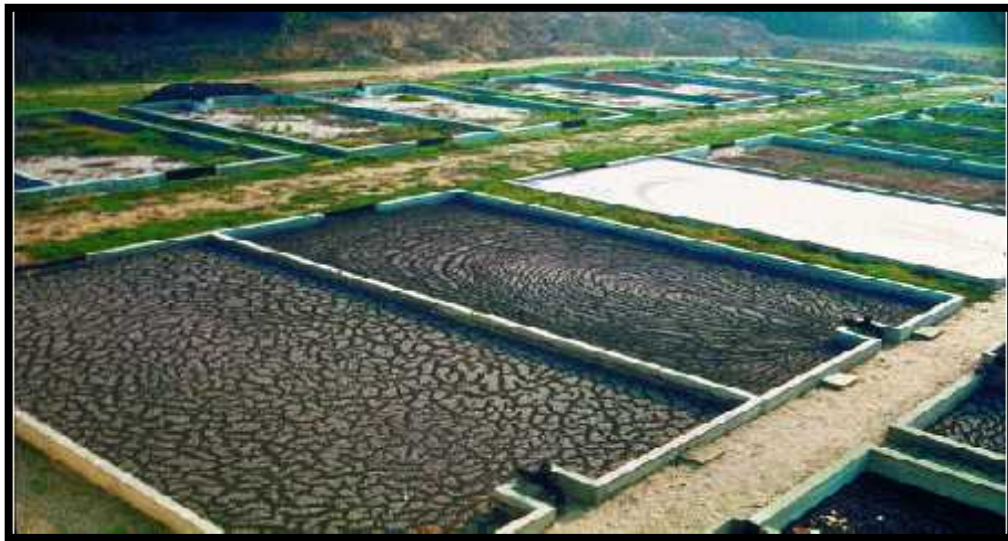
Figure II-16 : Lit de séchage
