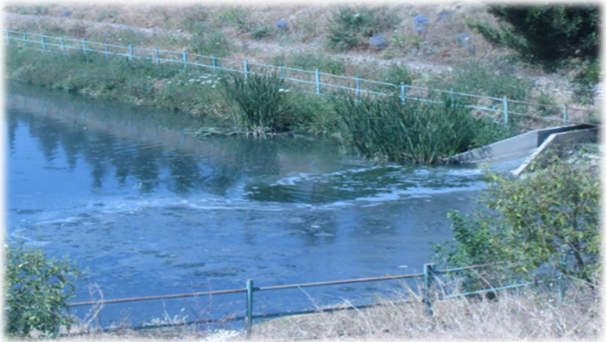
Figure V.4. Ouvrage d'alimentation et dégradation de l'aspect des lagunes de la STEP de Beni fouda
