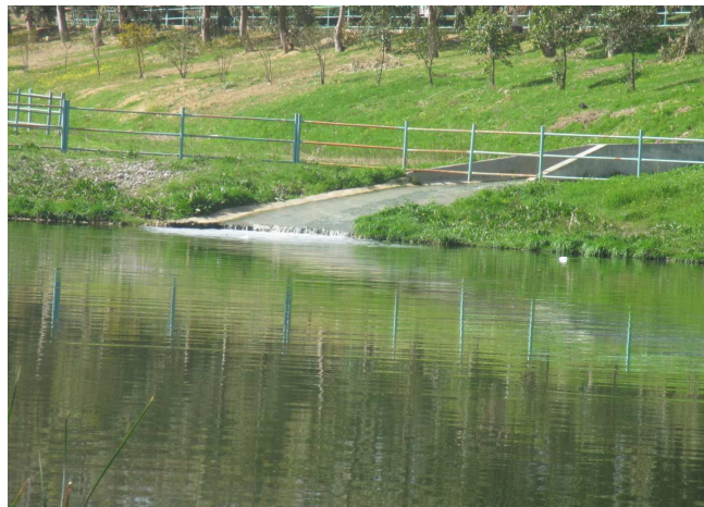
Figure 7: Canal d'alimentation de la lagune de maturation
