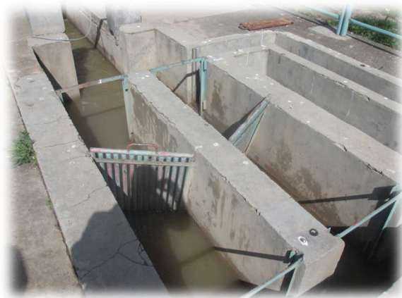
Figure 2 : Dégrilleur manuel de la STEP
