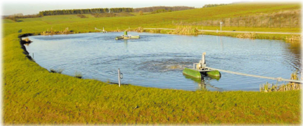
Figure V.9. Lagune aérée avec un aérateur de surface.
