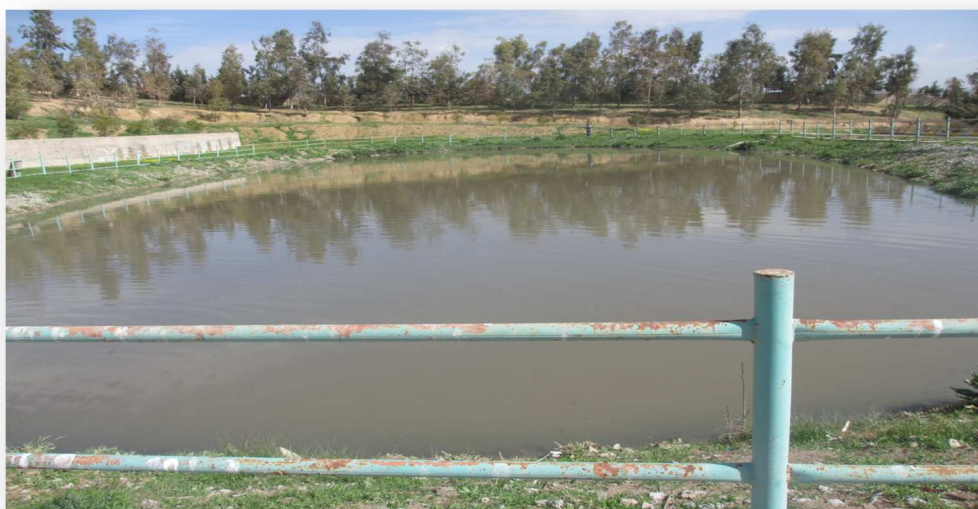
Figure 4 : Lagune de décantation
