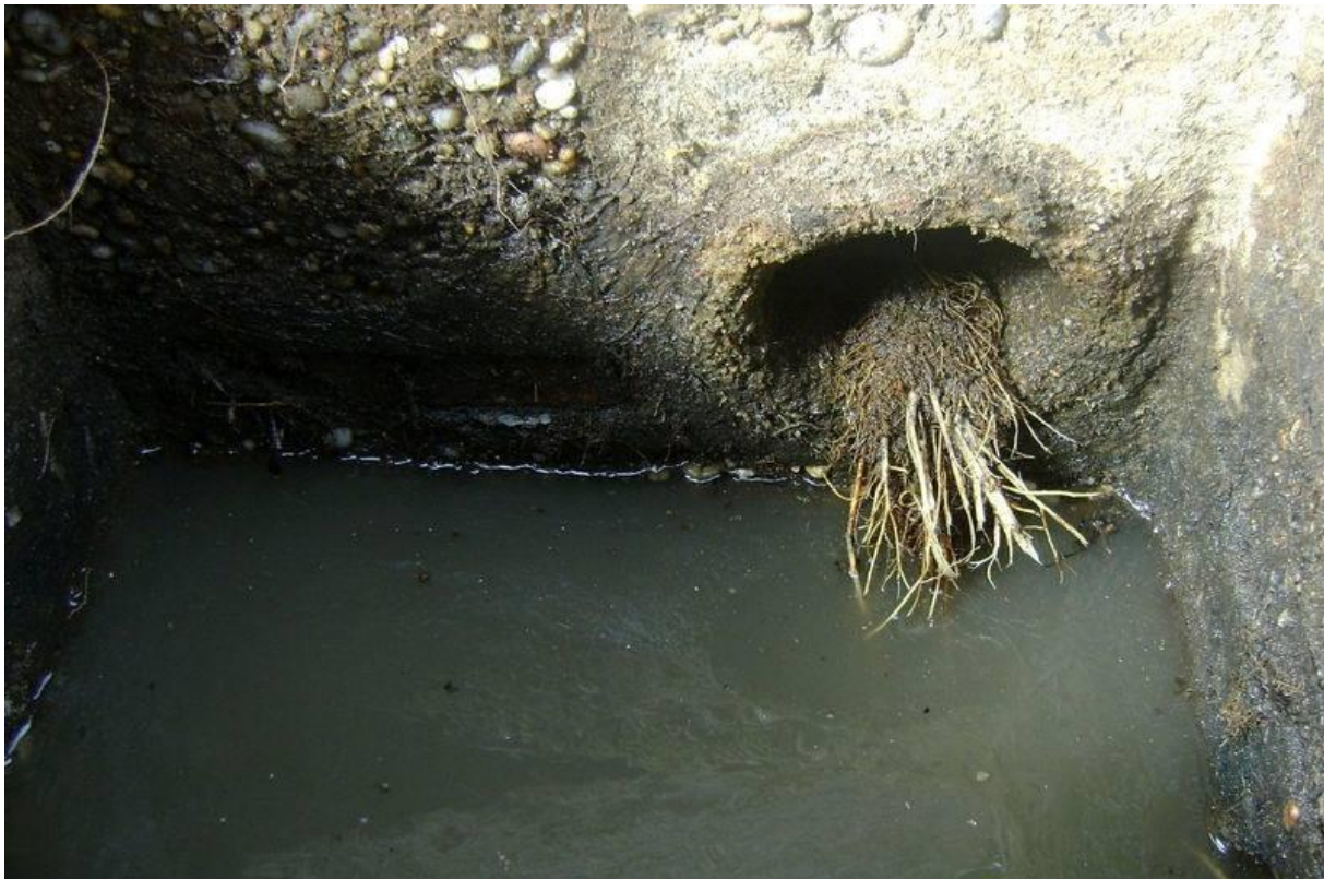
Figure VI.6 : Dégradations du réseau par les racines de végétaux
