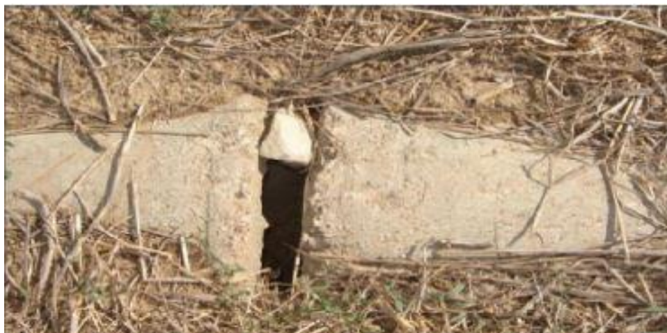
Figure II.7 : Déboîtement du collecteur apparent (au niveau des joints) (R115-R116)
