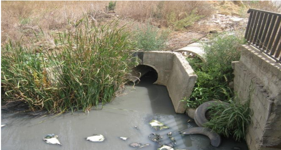
Figure II.4 : Rejet 1 vers l'Oued de Boukerrouche de DN800
