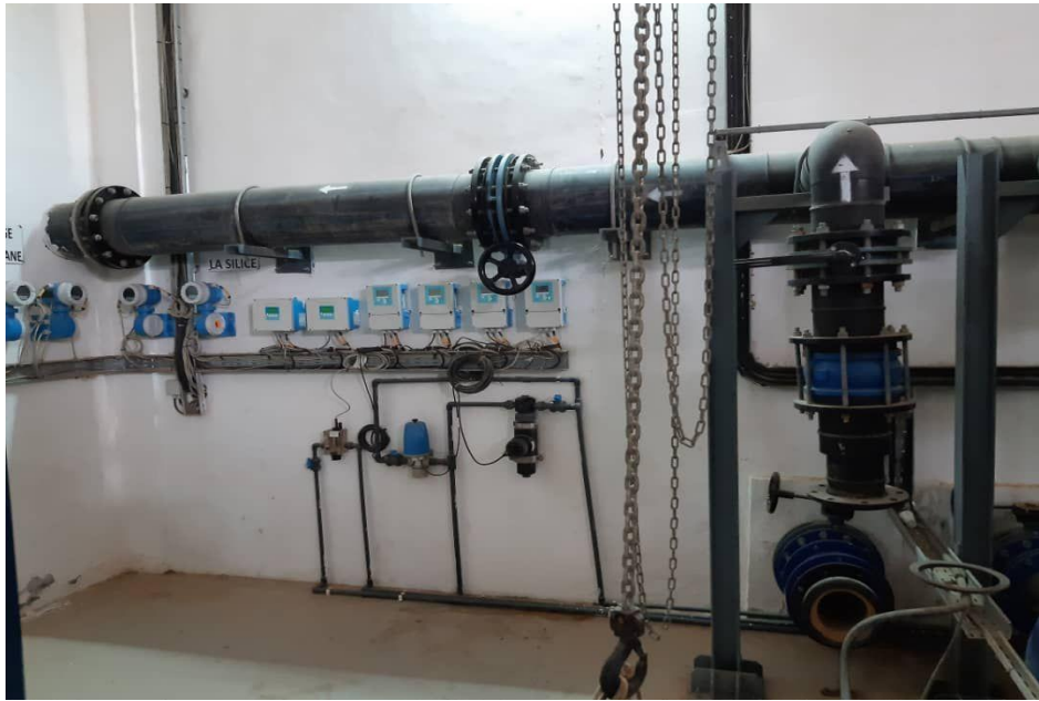
Figure IV.2. L'entrée d'eau à la station.
