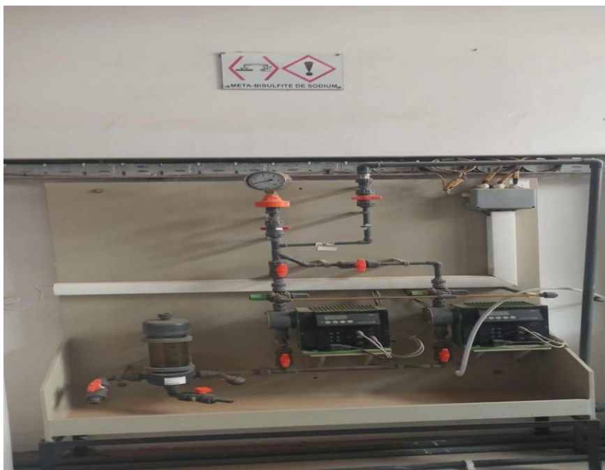
Figure IV.5. Injection de métabisulfite de sodium.
