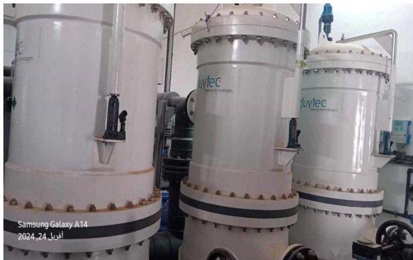
Figure IV.4. Les filtres à cartouches de la station d'IFRI.
