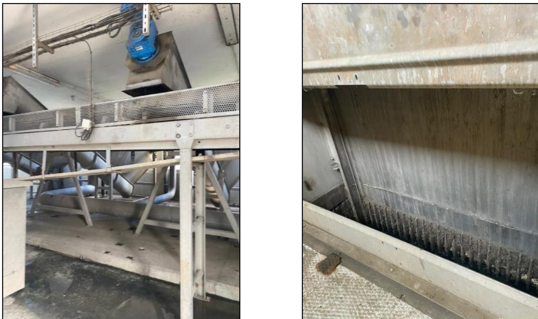
Figure III.4 : Photo des dégrilleurs de la STEP prise par (MAHIZI Anis, 19/02/23).
