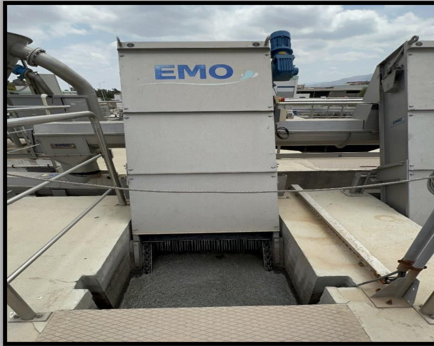
Figure I.6: Dégrilleur automatique fin (Photo prise à la STEP de Beni Mered)
