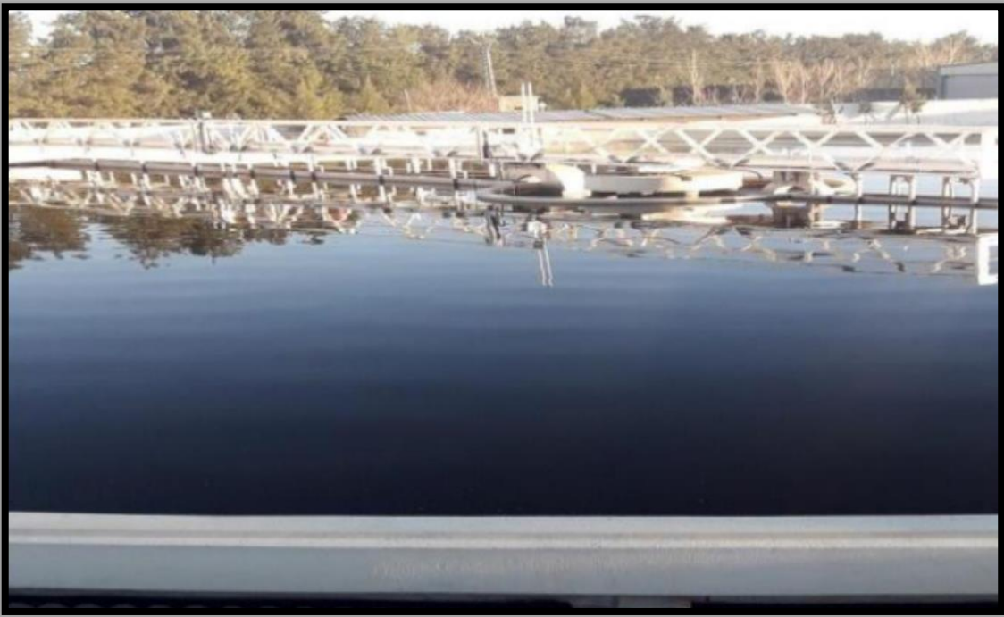
Figure I.13:Décanteur secondaire (Photo prise à la STEP de Beni Mered)
