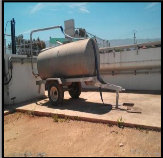
Figure I.9: Stockage des Sables (Photo prise à la STEP de Beni Mered)
