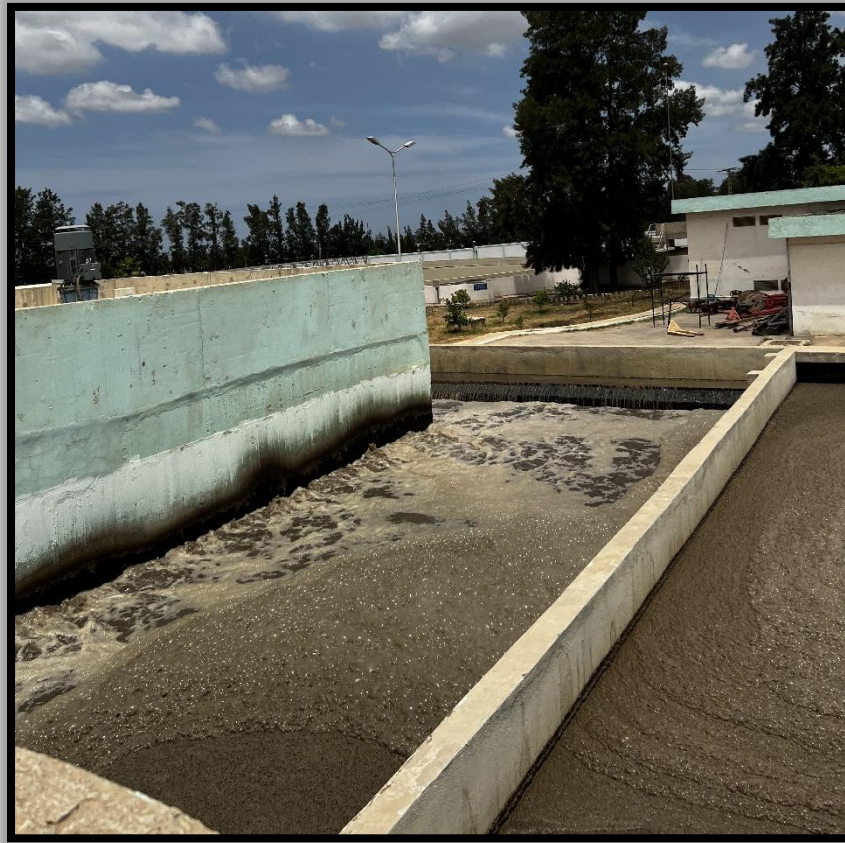
Figure I.12: Bassin d'aération (Photo prise à la STEP de Beni Mered)
