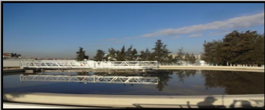
Figure I.11: Décanteur primaire (Photo prise à la STEP de Beni Mered)
