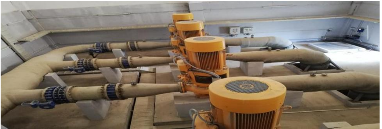
Figure III. 4: Réservoir de pompage (élaboré par l'étudiante)
