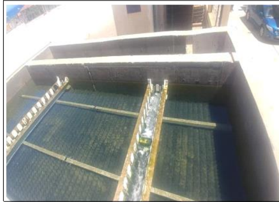
Figure 21: Décanteur lamellaire (Prise par l'étudiante)
