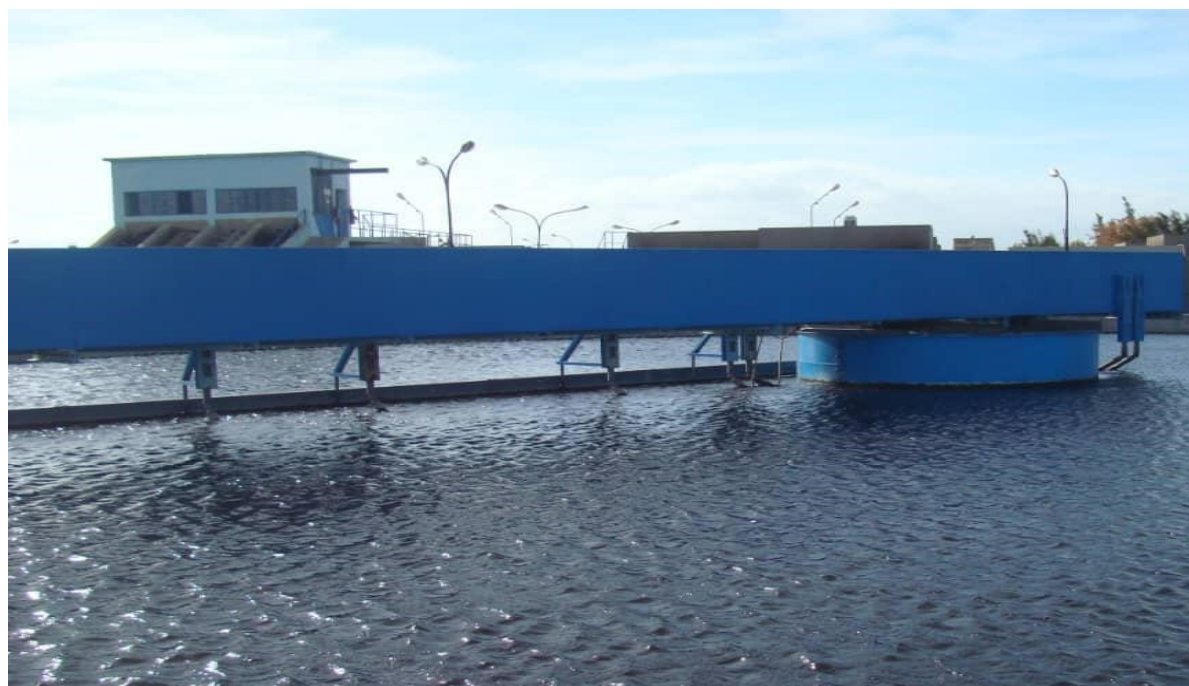
Figure IV.11 : Le décanteur secondaire de la STEP
