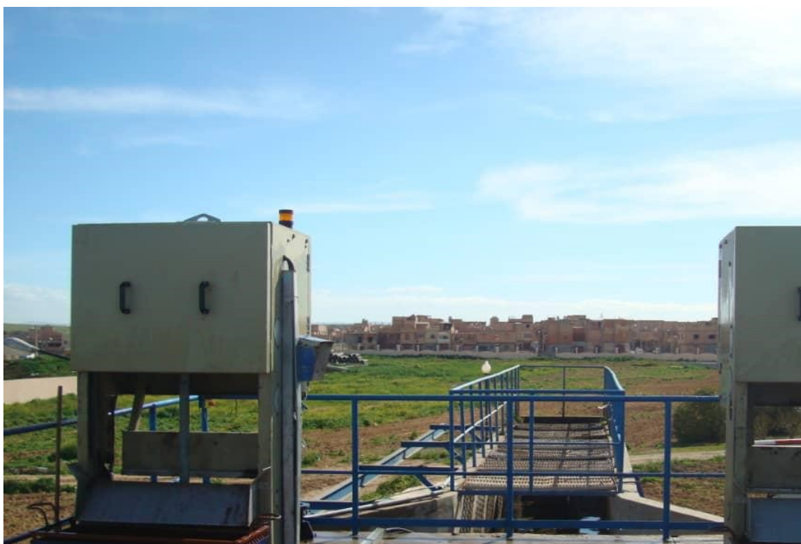
Figure IV.6 : Les deux grilles mécanisées de la STEP.
