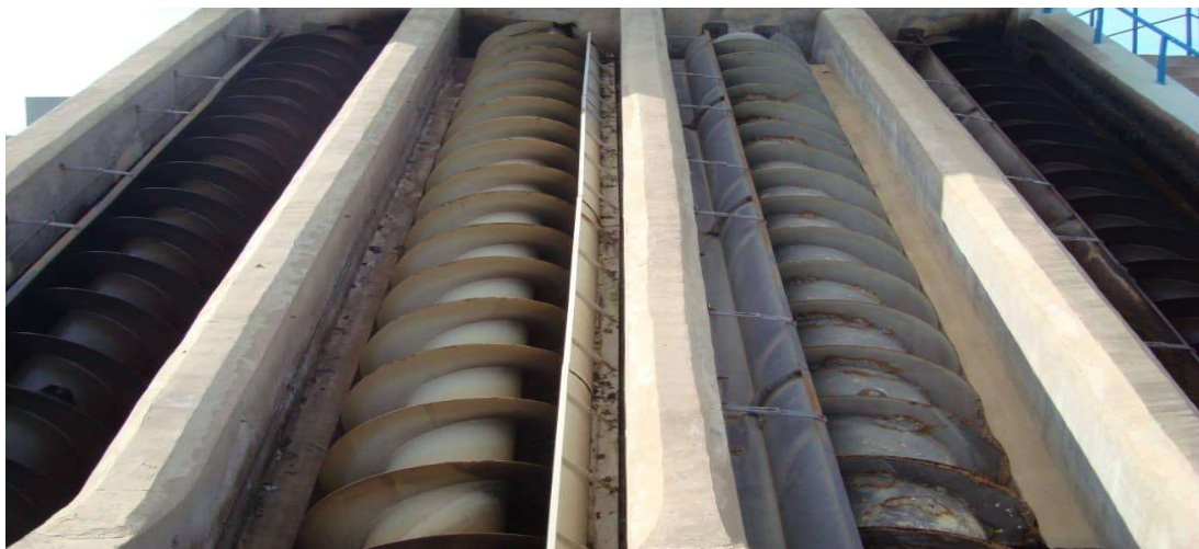
Figure IV.12 : Les vis d'Archimède (STEP SBA,2024).
