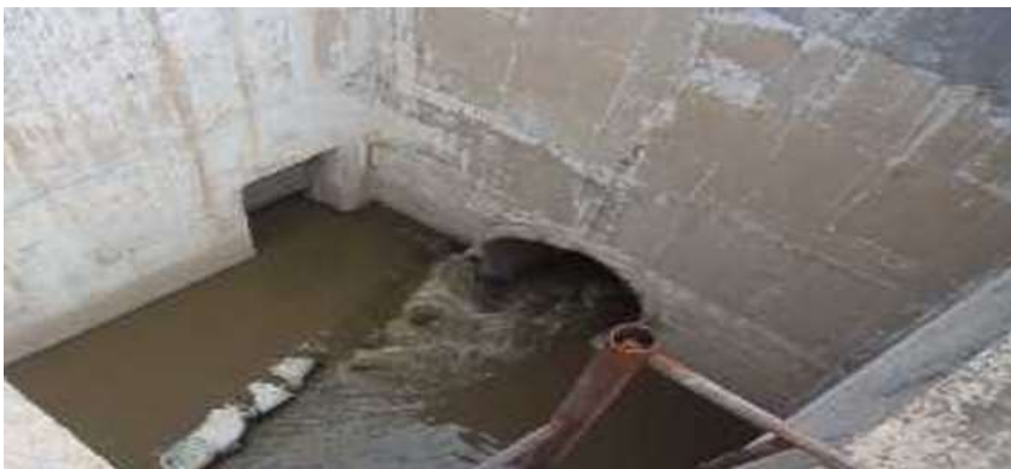
Figure IV.4 : Déversoir d'orage de la STEP [58].
