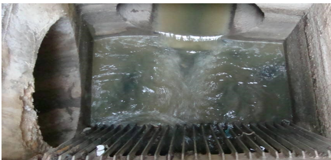
Figure IV.5 : La grille grossière de la STEP (entrée de l'eau dans la step).
