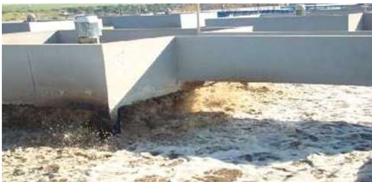
Figure IV.9 : Bassin d'aération de la STEP [58].
