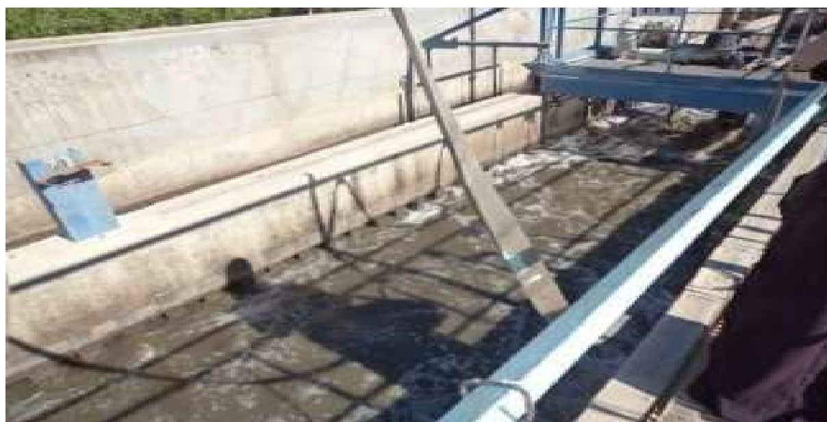
Figure IV.7 : Bassin dessablage-déshuilage de la STEP [58].
