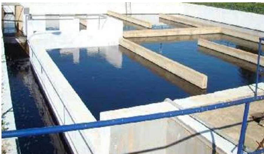
Figure IV.13 : Bassin de chloration de la STEP [58].
