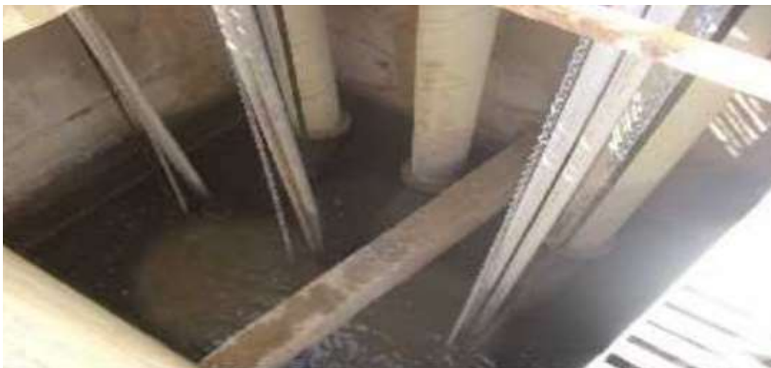
Figure IV.3 : Photo de relevage par des pompes [58].
