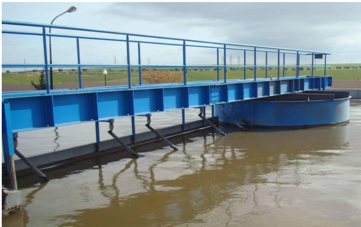
Figure IV.8 : Le décanteur primaire de la STEP
