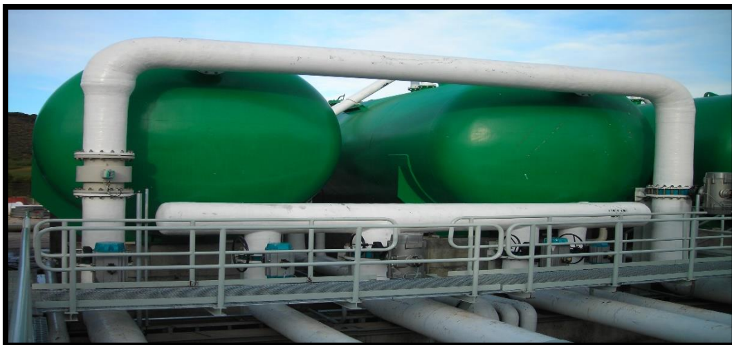
Figure III-6 : Les collecteurs des filtres
