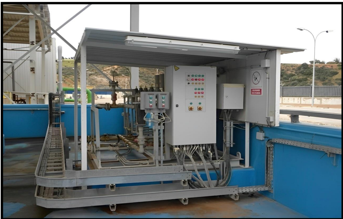
Figure III-12 : Station de contrôle pour dosage chimique
