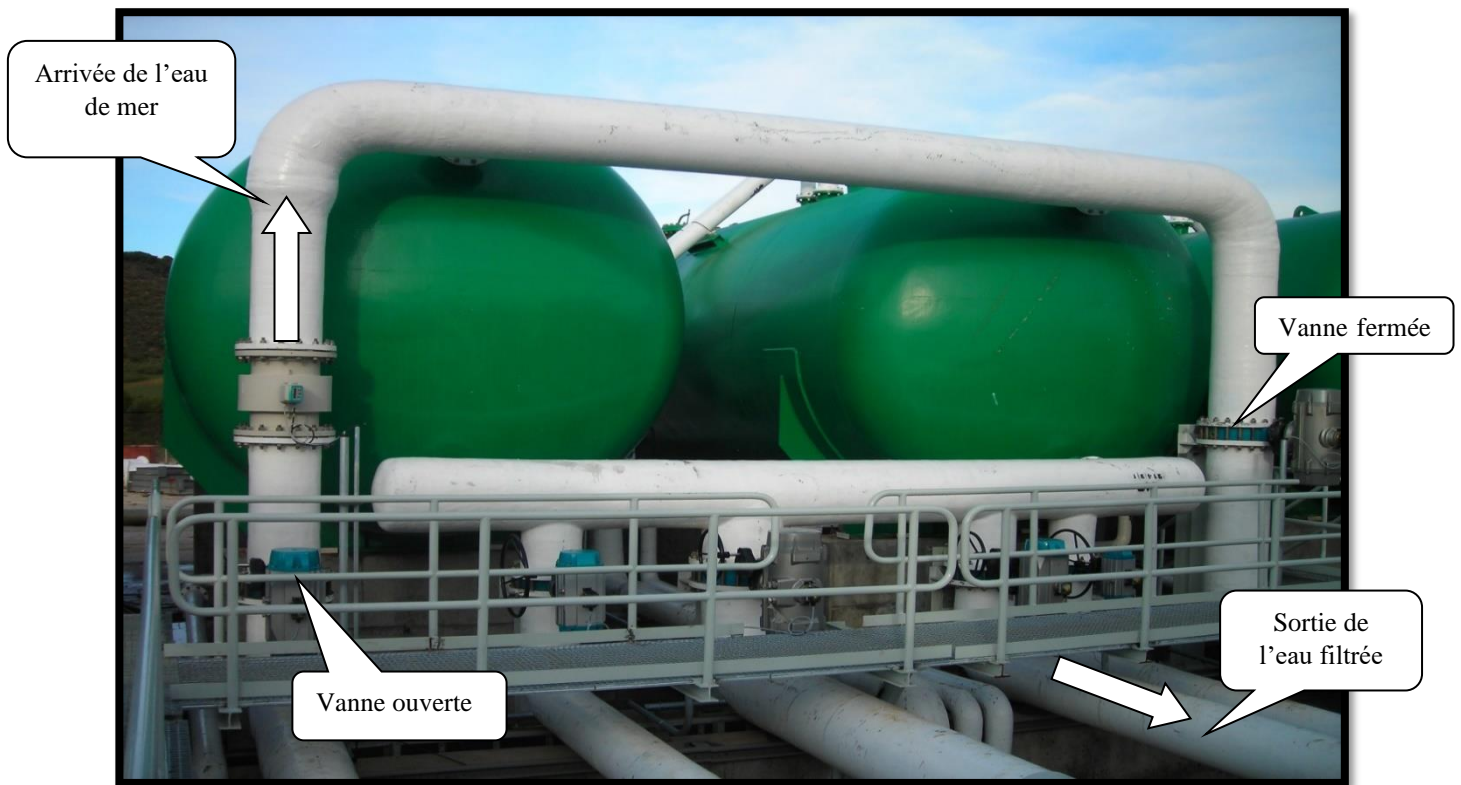
Figure IV. 3 : les ballons de filtration (arrivé et la sortie de l'eau)
