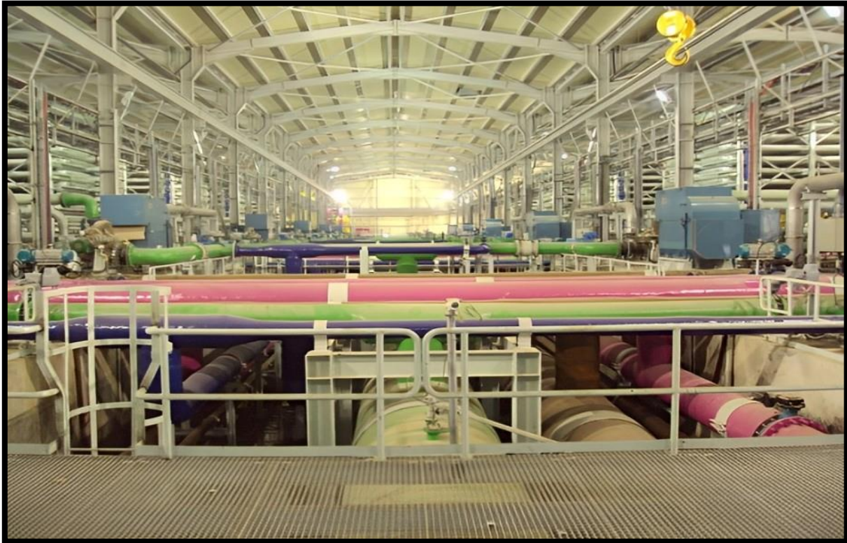
Figure III-13 : Ensemble des collecteurs et des tuyaux communs
