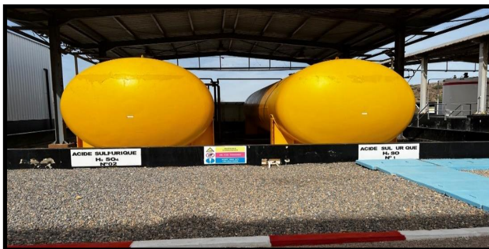
Figure IV.12 : Les réservoir acide sulfurique
