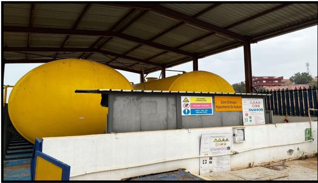
Figure IV.10 : Les réservoirs hypochlorite de sodium
