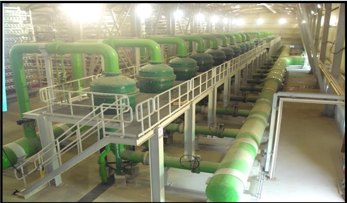
Figure III-8 : Les Filtres à Cartouches
