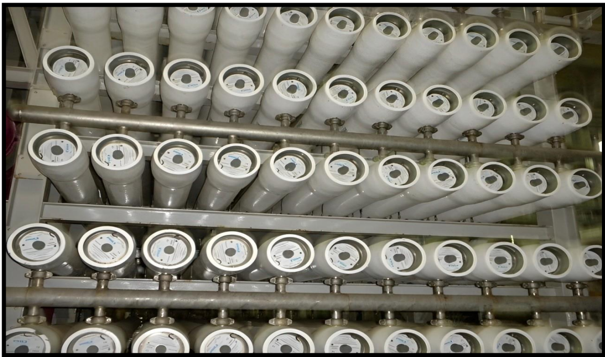
Figure III-9 : Modules d'osmose inverse
