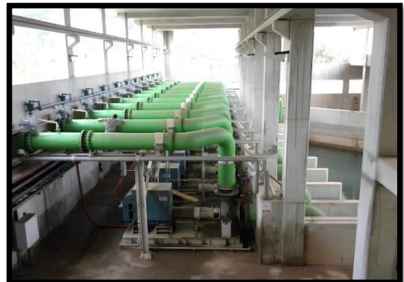
Figure III-4 : Les pompes de captage
