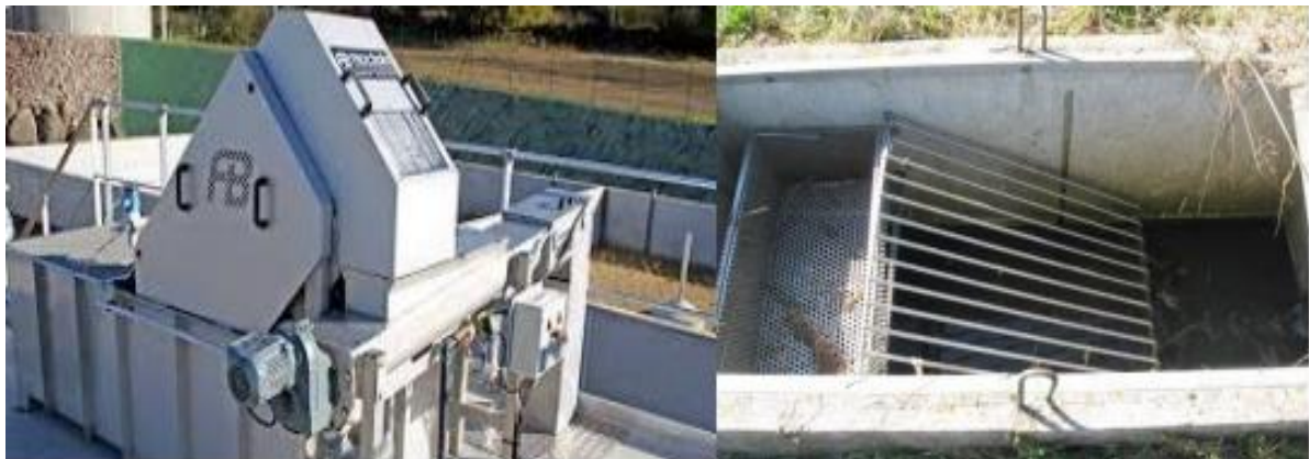
Figure II.2 : dégrilleur automatique et manuel.
