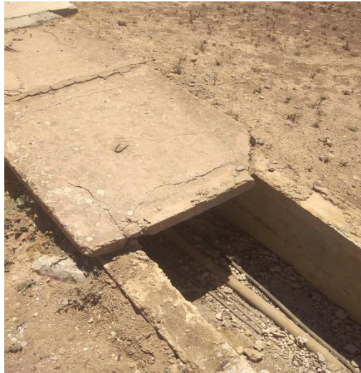
Figure III.16 : Couvertures des passages de câbles (Mai ,2024)
