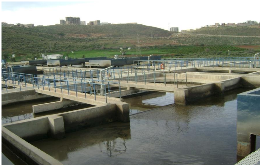
Figure II.7 : Le bassin d'aération [10].
