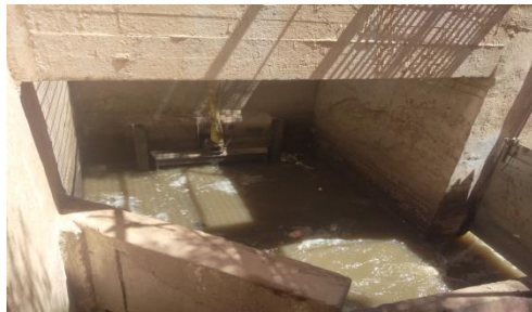
Figure III.12 : Etat de la vanne murale (Mai ,2024)
