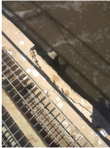
Figure III.11 : Etat du dessableur-deshuileur (Mai, 2024).
