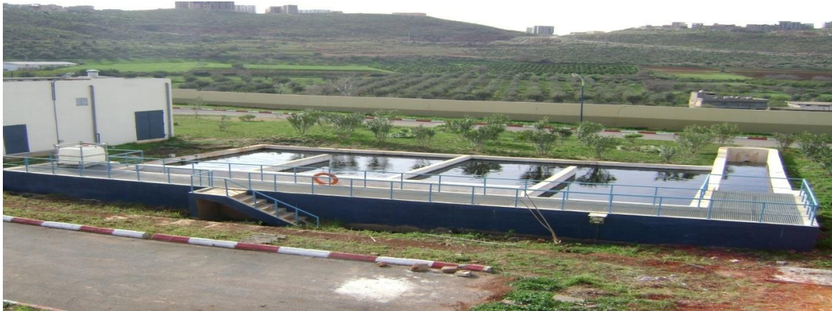
Figure II.9 : bassin de chloration [10].
