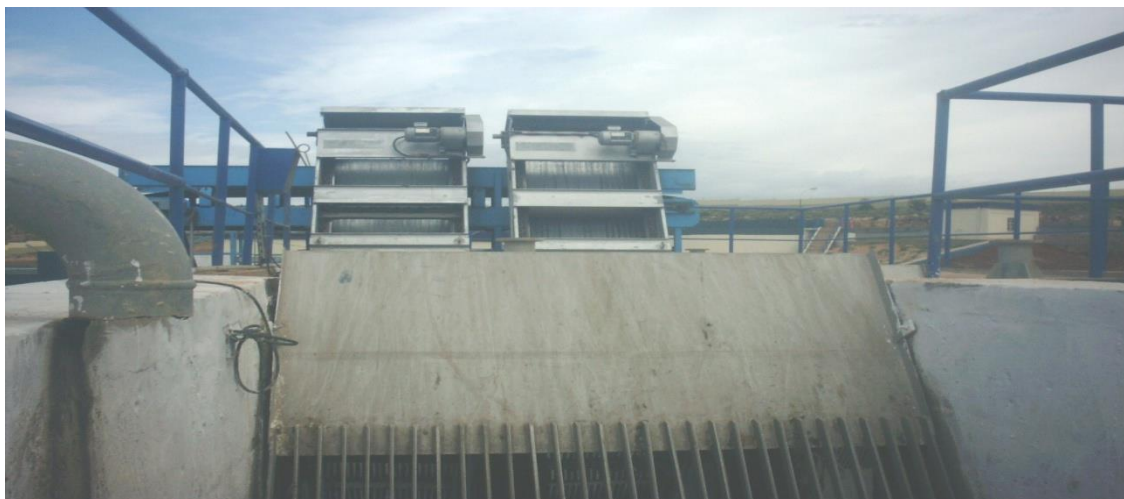
Figure II.3 : la grille grossière manuelle (2024).
