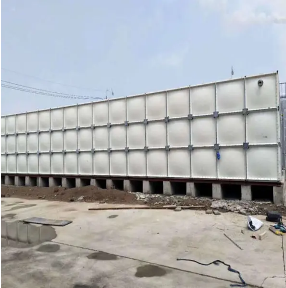
FIGURE 3.16 – réservoir d'eau filtrée
