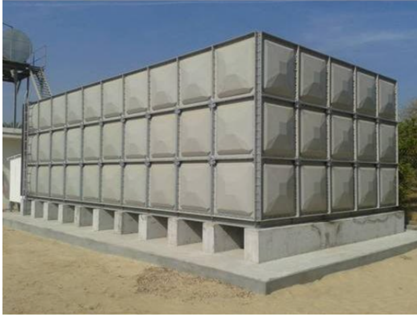
FIGURE 3.22 – Réservoirs de Stockage pour l'Eau Reminéralisée
