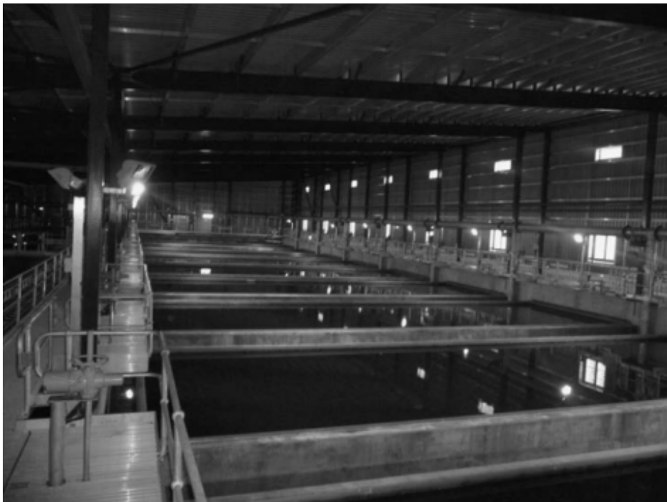
FIGURE 3.12 – filtres à gravité à un seul étage à l'usine de dessalement SWRO de Gold Coast, Australie.[9]
