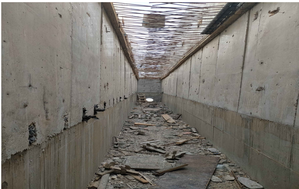
FIGURE 4.3 – Canal intérieur du filtre à sable
