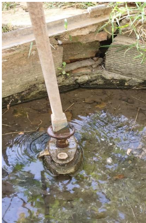
Figure III.9 : vanne du réservoir 500 m 3 (Juillet2024)
