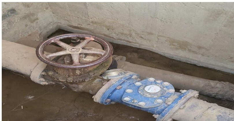
Figure III.6 : Vue de l'intérieur De la chambre des vannes du réservoir (juillet 2024)
