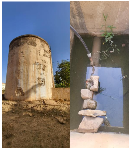
Figure III.8 : Réservoir 300 m 3 (juillet2024)
