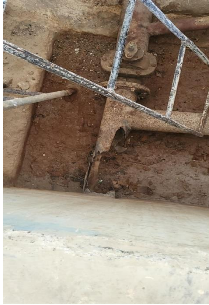
Figure III.10 : Conduite de vidange cassée (juillet 2024)
