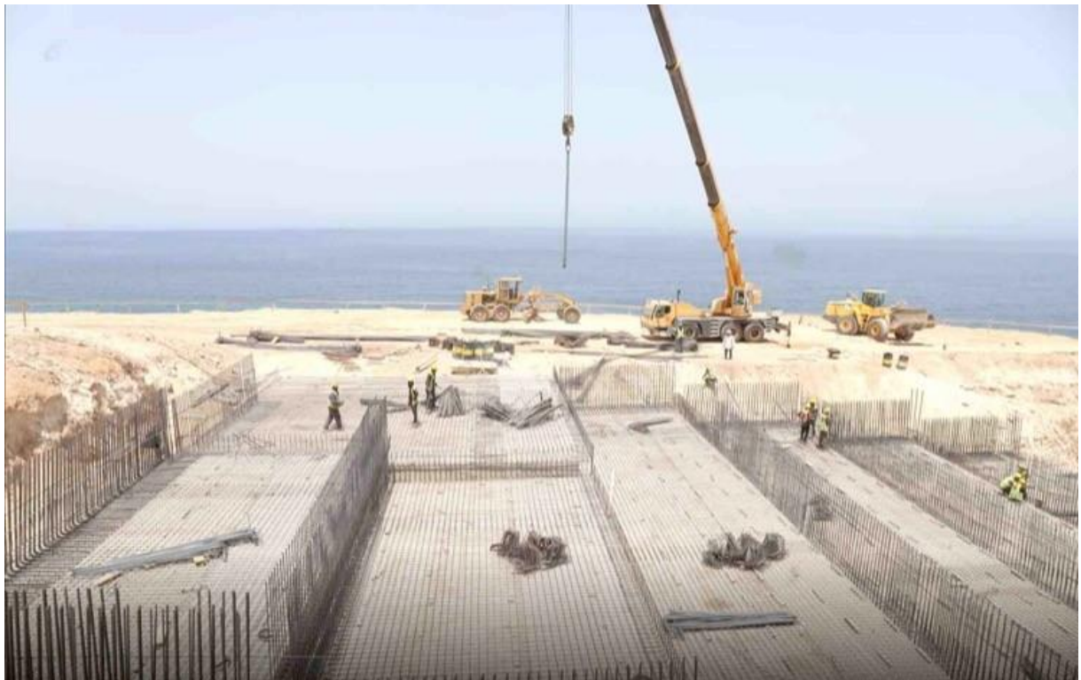
Figure I.4 : Station de dessalement de Cap Blanc à Oran
