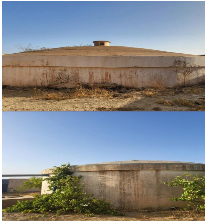
Figure III.5 : Réservoir semi-enterré de capacité de 2*1000 \text{ m}^3 (juillet 2024)
