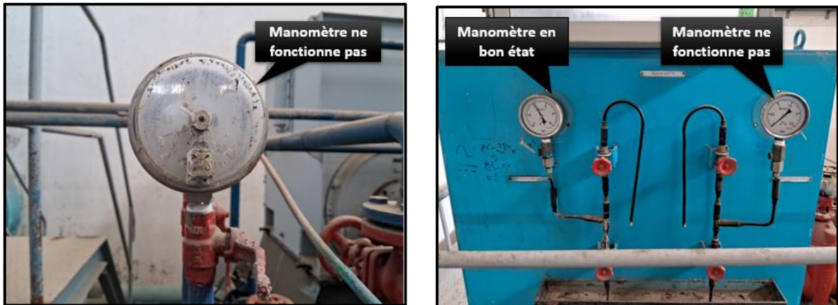
Figure IV.2 : L'état des équipements de mesure (Date : 21/05/2024)
