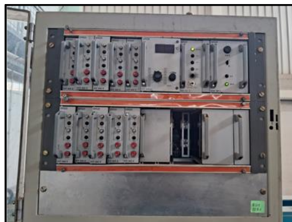
Figure IV.4 : Armoire électrique (Date : 21/05/2024)
