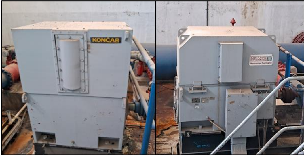
Figure IV.5 : Moteurs d'entraînement des pompes (Date : 21/05/2024)
