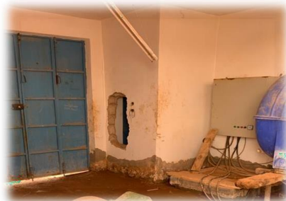
b) Armoire de commande de la pompe
