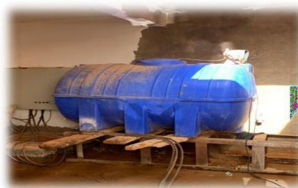
d) Citerne de javellisation pour le traitement d'eau
