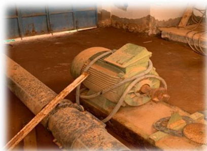
c) Moteur électrique de la pompe
