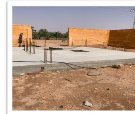
d) l'enceint forage de Guifla
