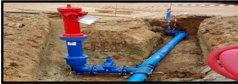
Figure VIII. 6 : Le poteau d'incendie.
