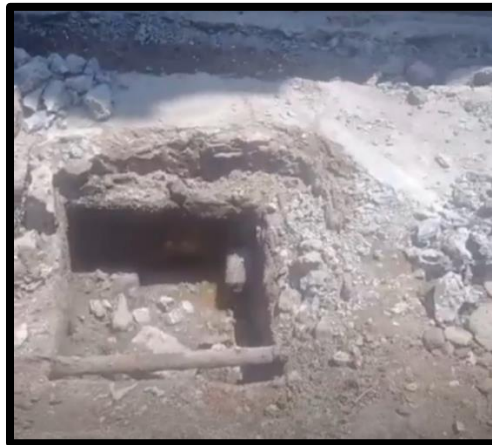
Figure I.14: Image d'une conduite d'AEP passant à travers un regard d'assainissement
