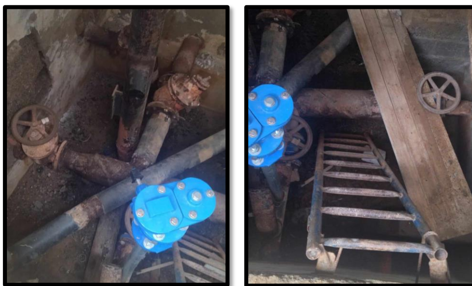
Figure VI.19 : Les conduites du réservoir semi-enterré Thiouririne
