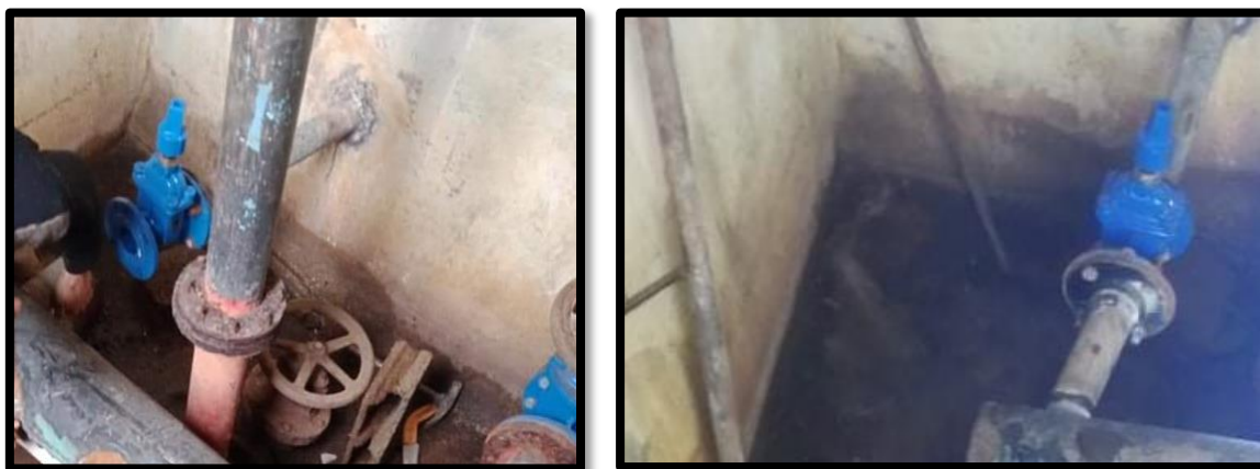
Figure VI.17 : Les conduites du réservoir Idheriken
