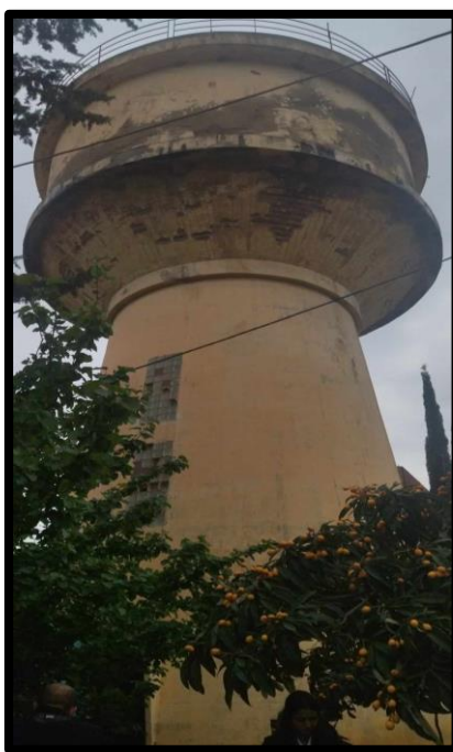
Figure VI.13 : château d'eau de volume 400 m 3 du Centre-Ville Tazmalt (Source : APC Tazmalt, Mai 2024)
