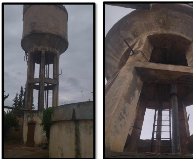
Figure VI.20 : Le réservoir surélevé Thiouririne de volume 200 m 3
