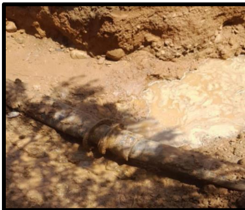
Figure I.15: Image d'une conduite endommagée avec une fuite importante
