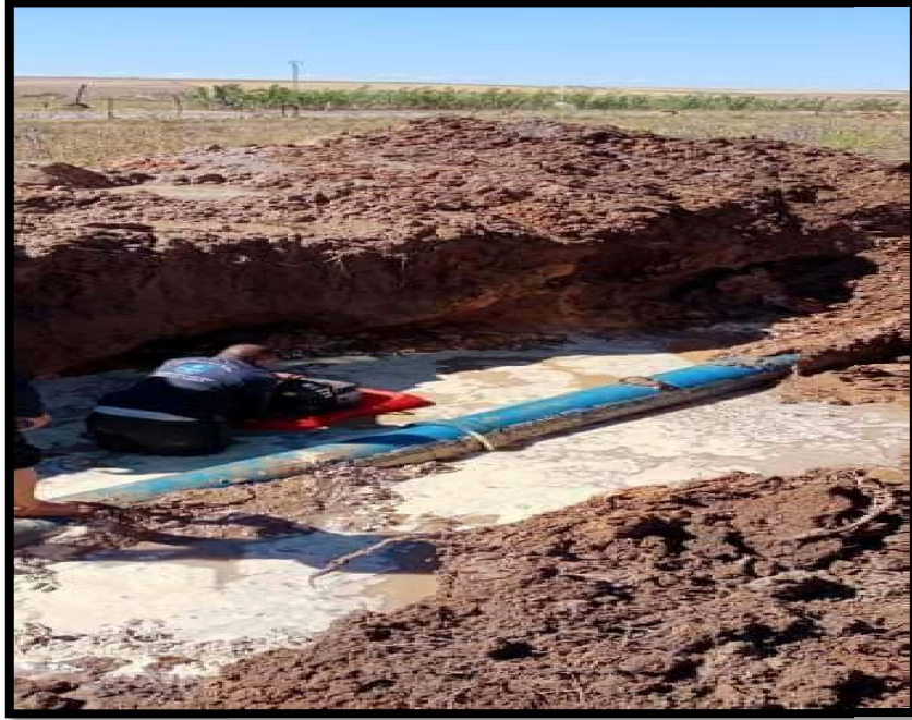
Figure III.8: Des conduite de d'adduction en Mauvais état (2024)
