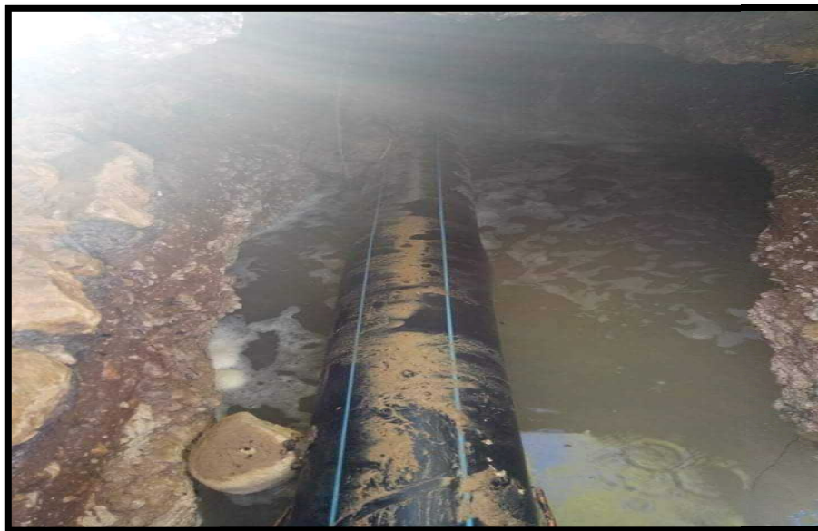
Figure III.9 : Des conduite de distribution en Mauvais état (2024)
