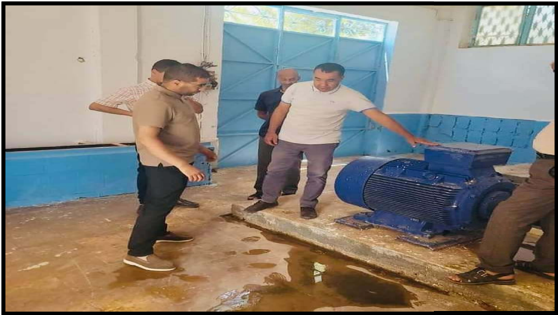
Figure III.5 : Station de pompes Nouasser (02 juin 2024)
