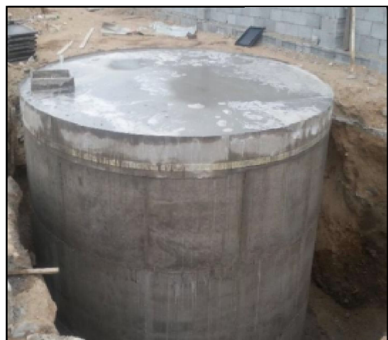
Figure V.6: Réservoir enterré (Source : S2e77)
